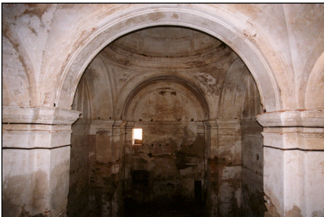
Imagen 12: Estado en el que se encontraba la Iglesia antes de las obras.
