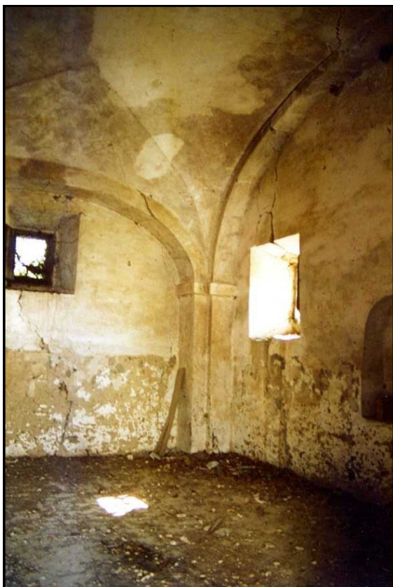
Imagen 14: Estado en el que se encontraba la Iglesia antes de las obras.
