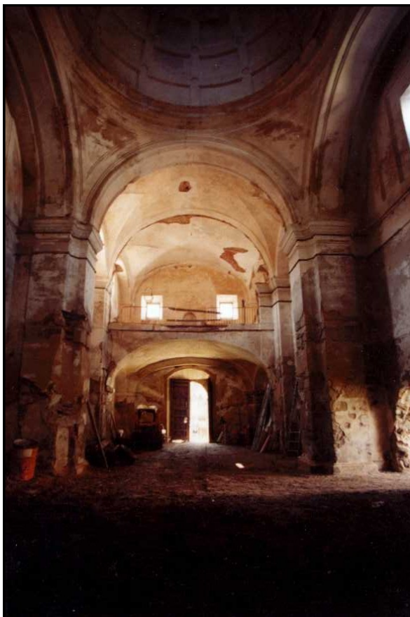
Imagen 11: Estado en el que se encontraba la Iglesia antes de las obras.
