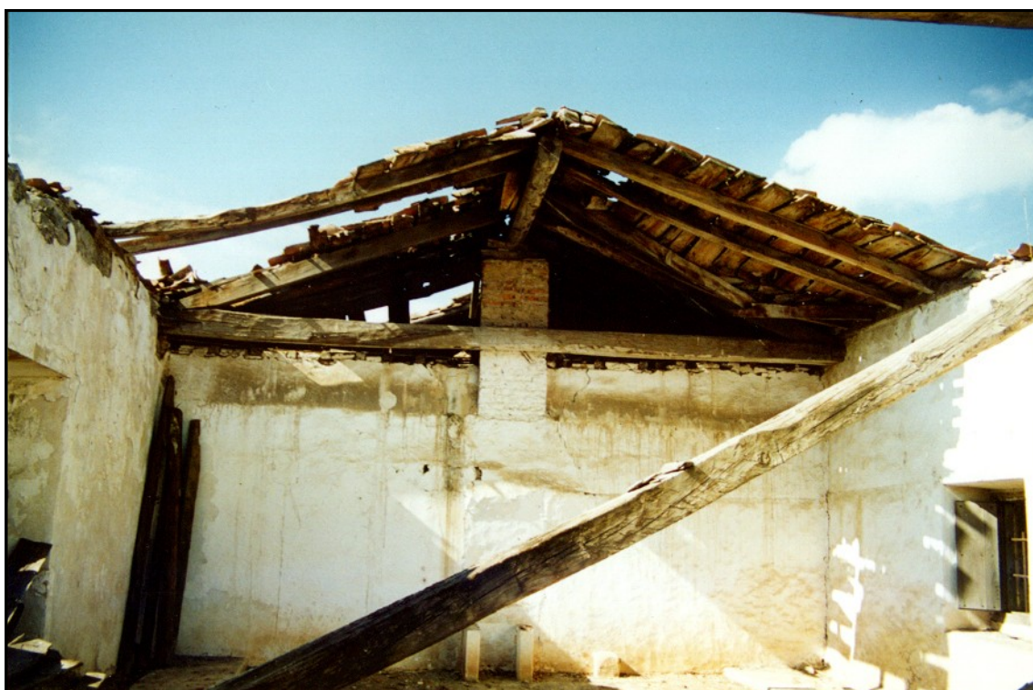
Imagen 31: Estado lamentable del bajocubiertas.
