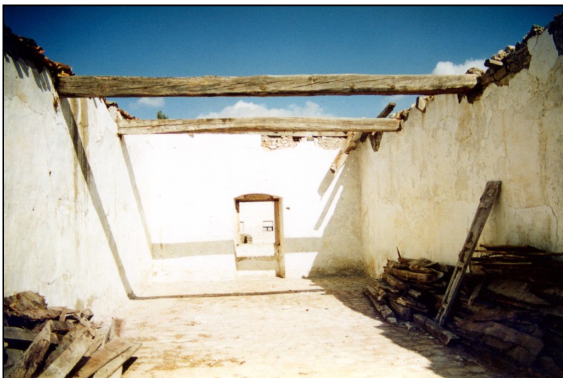
Imagen 30: Estado lamentable del bajocubiertas.
