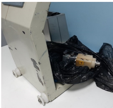
Figura 5.23. Ánodo 18 F-F y mampara plomada de protección durante el mantenimiento del blanco.
