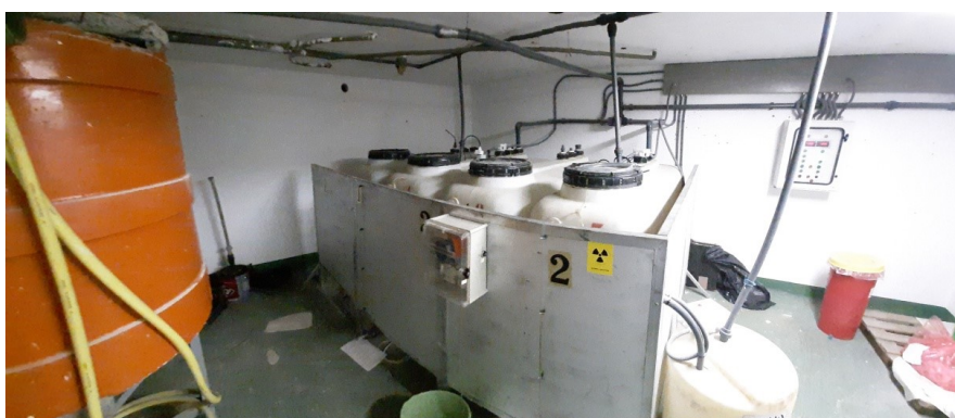
Figura 2.20. Depósitos para el almacenamiento de residuos radiactivos líquidos generados en Medicina Nuclear.
