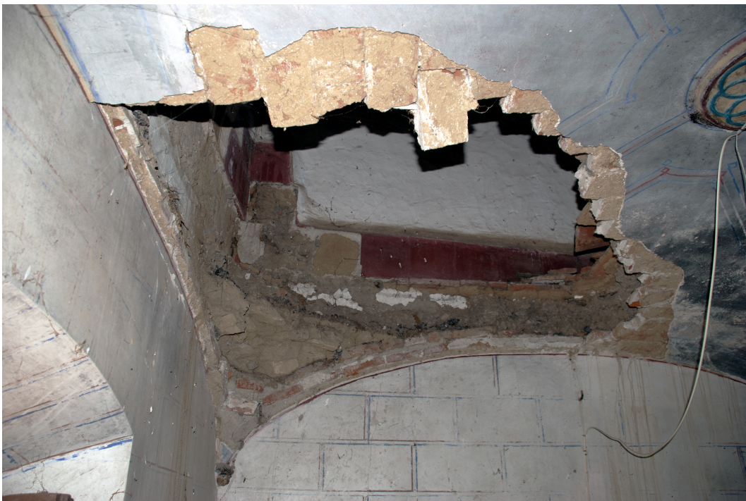
Figura F.7: Bóveda Extremeña con fábrica a panderete. En c/ Rodríguez Sánchez nº 13, Casas de Reina (Badajoz).
