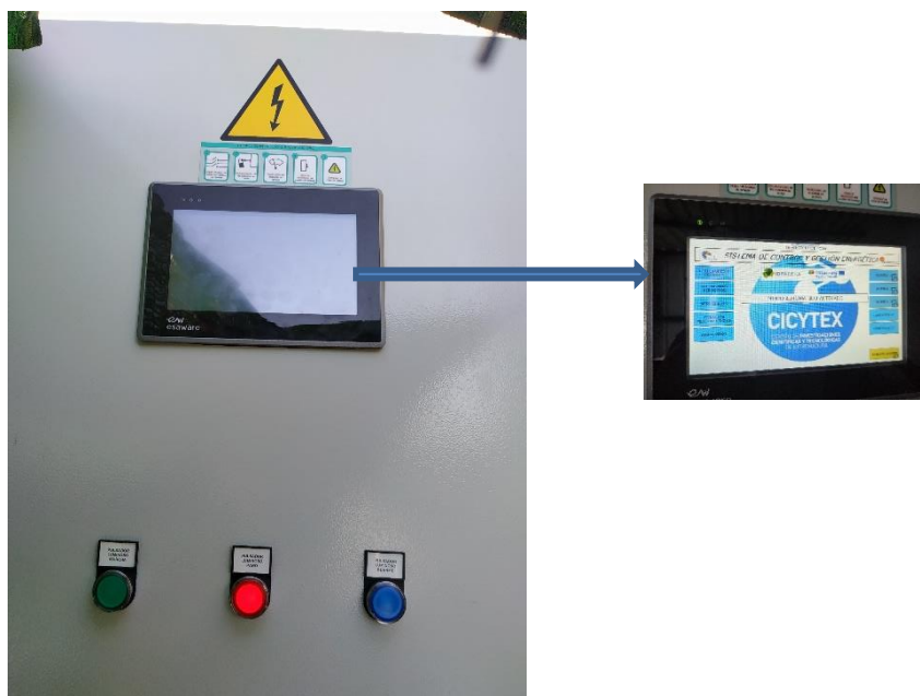
Figura 56. Cuadro de control del prototipo solar Fresnel.
