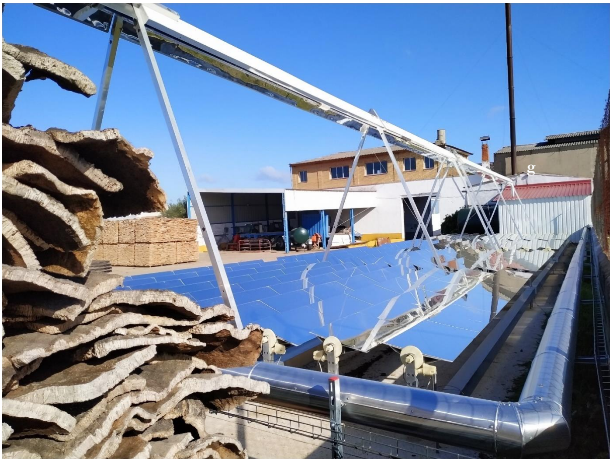
Figura 55. Colector Fresnel instalado en la corchera.
