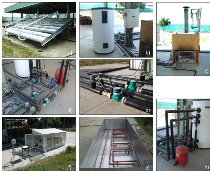
Figura 6. Planta de cocción de corcho y sistema de evaporación y secado. [67]
