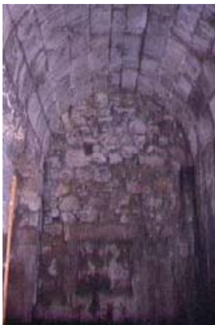
Bóveda de medio cañón de cantería de piedra situada en el interior de la presa
