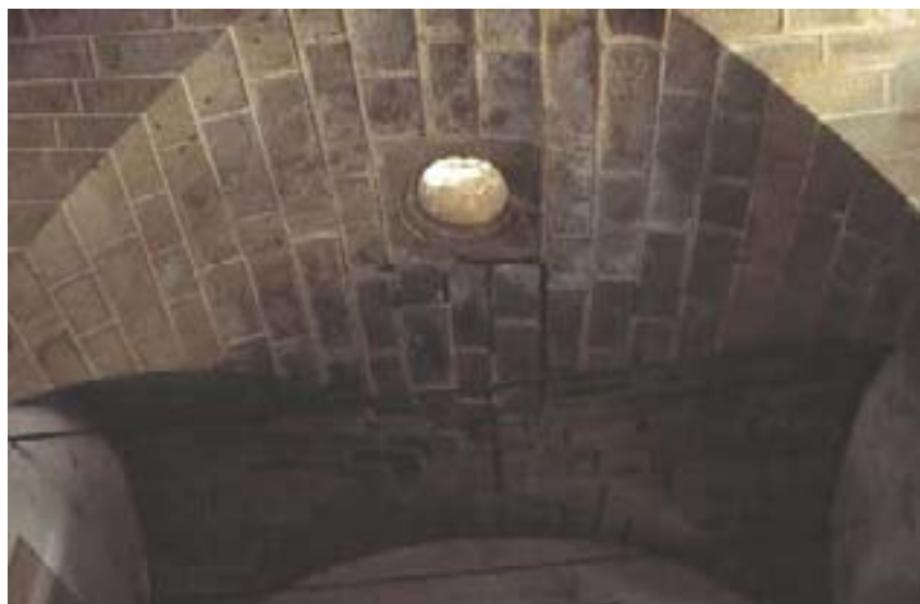
Detalle de la misma bóveda con un óculo que ilumina la estancia
