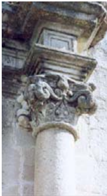
Detalle de uno de los capiteles de la portada principal de la iglesia
