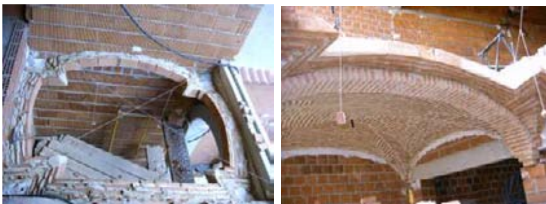
Construcción de una bóveda de ladrillo sin cimbra (izq) y una ya concluida (der)
