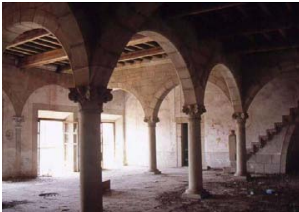
Arquerías de la primera planta del Palacio de "Santa Marta" de Trujillo
