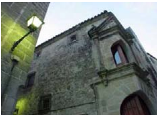
Mampostetría y sillares de piedra de la Casa de los Cháves-Calderón (Trujillo)
