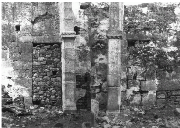
Fotografías 004 y 005: Puertas tapiadas Norte y Sur de acceso al Interior de la nave (fotografías inéditas cedidas por Juan Rosco y M a Luisa Téllez)
