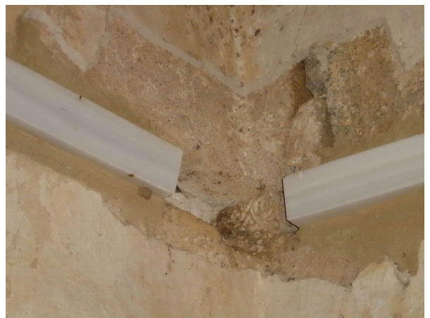
Fotografía 163: Resto de friso de mármol aun en su posición original (ábside central) sin visos de solución en encuentro con pieza correspondiente de muro transversal (fotografía del autor).
