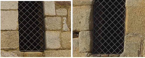
Fotografías 155 y 156: Ventanas de los ábsides en los que se aprecia el retalle para acoger la celosía para tamizar la luz en los ábsides (fotografías del autor)
