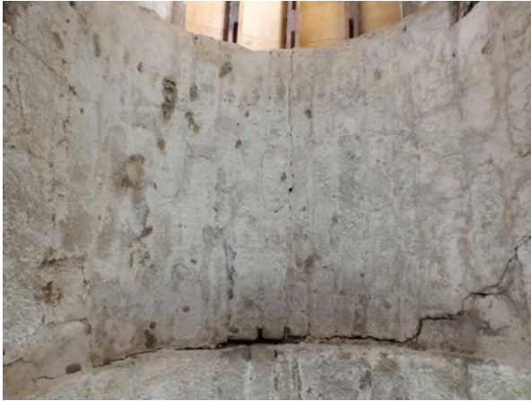
Fotografía 137: Bóveda del coro y encuentro con su arco de acceso correspondiente (fotografía del autor)
