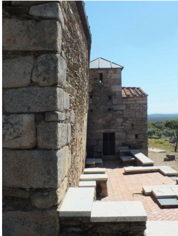
Fotografía 192: Apreciable desplome del muro Sur de la nave (fotografía del autor)
