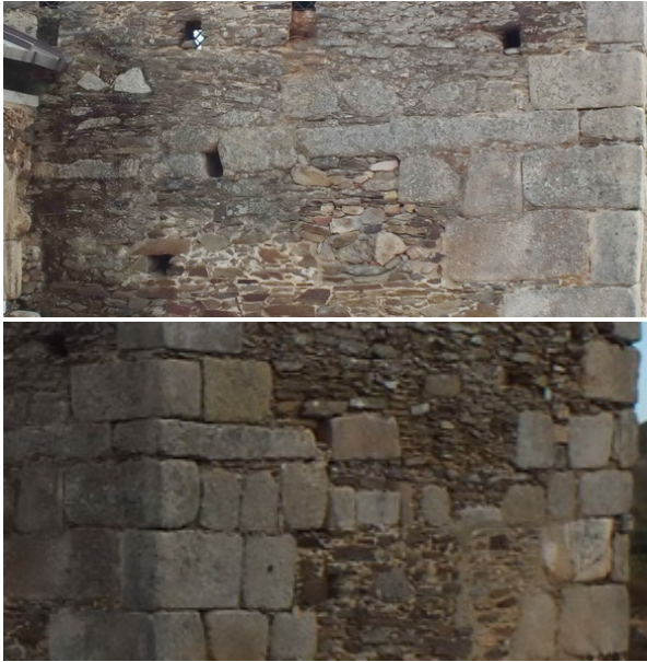
Fotografías 184 y 185: Encadenados lineales en los muros lateral Norte y testero Oeste de la nave (fotografías del autor)
