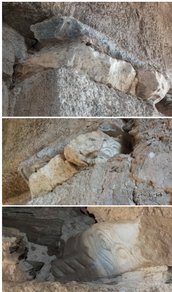
Fotografías 166, 167 y 168: Restos de cimacios, arriba el correspondiente a los arcos fajones del transepto, abajo el de arcos de acceso a ábsides o coro. La tercera foto, del cimacio del arco de acceso al ábside Sur, se percibe un sogueado estilizado (fotografías del autor).
