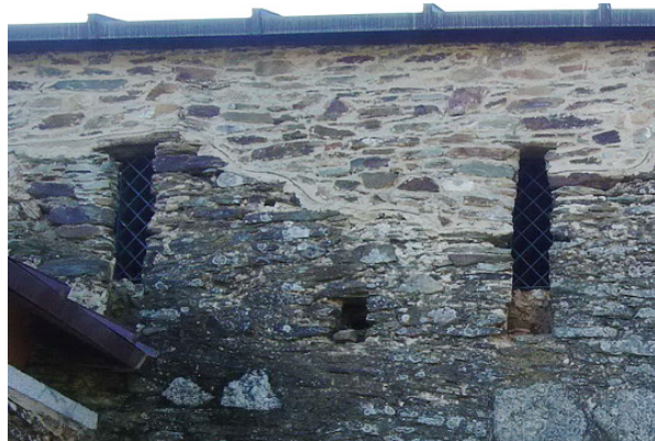
Fotografía 142: Ventanas aspilleras segunda y tercera del muro Norte de la nave. Se advierte el encintado de latón que marca el límite entre la fábrica existente y la restaurada, por encima del dintel de la aspillera segunda,
