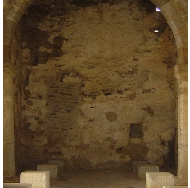
Fotografía 190: Muro testero Oeste. Se aprecia la falta de sillar en zona de posible enjarje con arcada Norte de la nave; la zona simétrica de posible enjarje con arcada Sur está alterada por la existencia de un hueco ahora tapiado (fotografía del autor)
