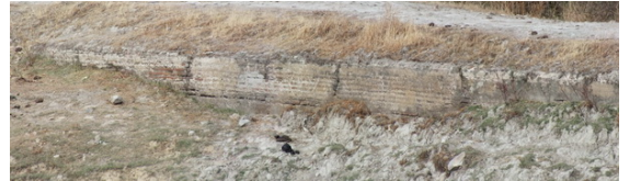
Fotografías 080 y 081: Charca de Santiago, conocida como "presa romana". Detalle del muro de contención, varias veces reformado (fotografías del autor)
