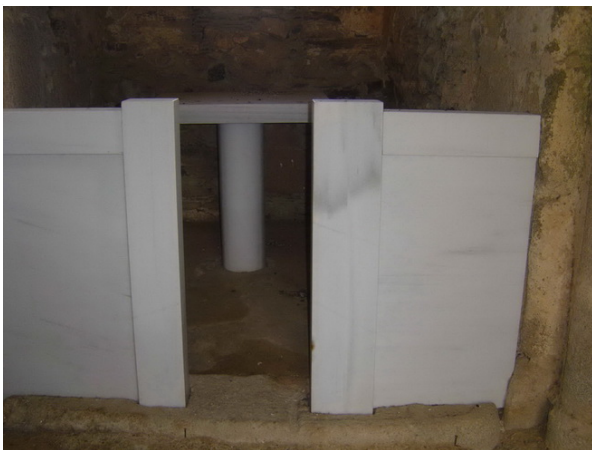
Fotografías 161 y 162: Canceles de mármol ocupando el lugar de los originales en ábsides Norte y Sur, con dimensiones ajustadas a las hendiduras marcadas en umbrales y jambas. No solo el del ábside Norte no presenta barroteras y el del Sur sí, sino que, incluso, las dimensiones de tales elementos son diferentes en el lado izquierdo y el derecho (fotografías del autor)
