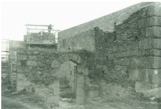
Fotografía 012: Trabajos de recricido de muros de nave y cimborrios (fotografía inédita cedida por el Constructor Antonio ABREU)
