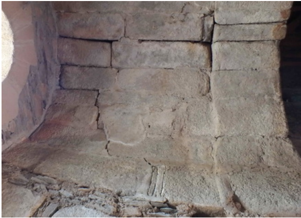
Fotografía 194: Se aprecia la apertura de junta en diagonal, indicando el desplazamiento del vértice Sureste del ábside Sur (fotografía del autor)
