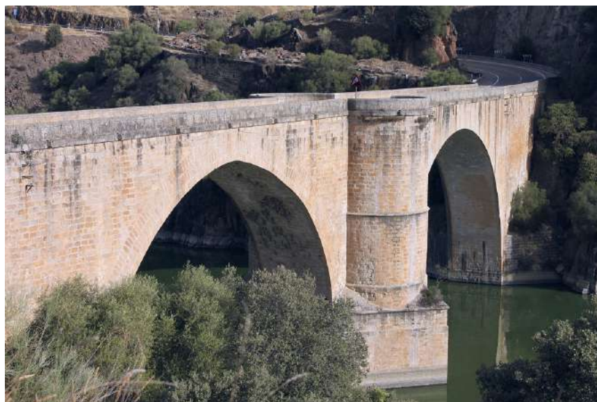
Figura 16. El puente de Almaraz con el camino hacia esta localidad, inicio de la obra del tramo caminero a construir en 1764.
