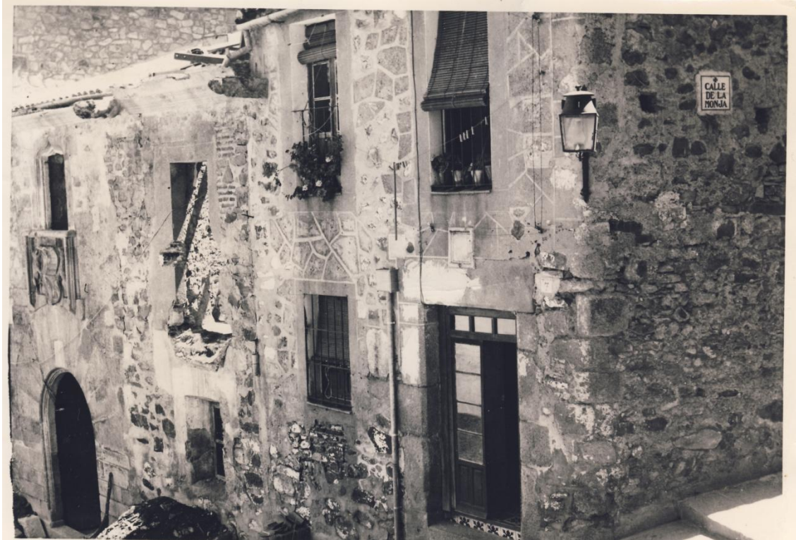
38. Estado del inmueble durante la intervención de 1965. Se aprecia la completa ruina interior, pero se mantienen ciertos elementos singulares tales como la fachada y la escalera (AHMC).
