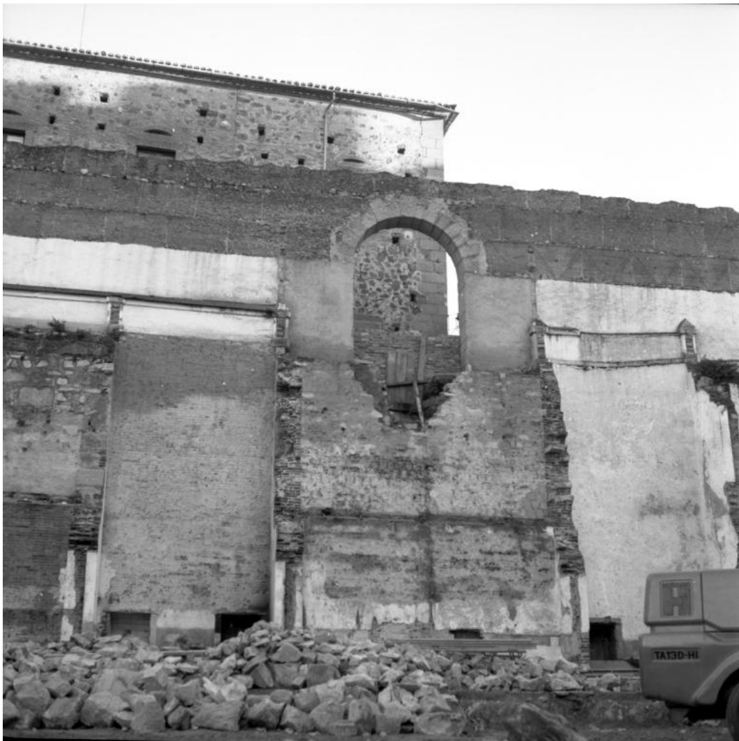
48. Estado del muro tras el derribo del mercado hacia los años 70. El tapial que presenta en la zona superior es diferente al que hoy podemos observar (AHMC).
