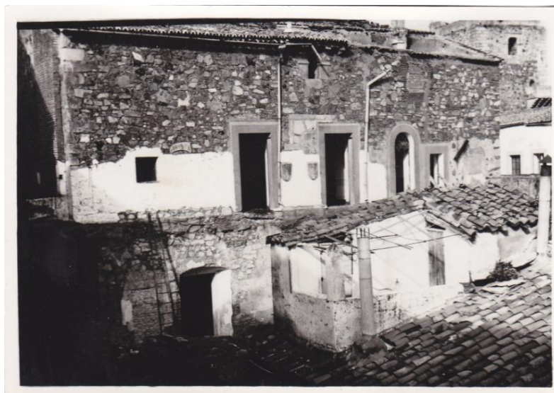
63.Estado de la fachada del patio del palacio de Carvajal, con anterioridad a su intervención.
