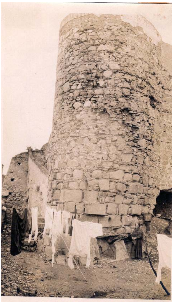
132. Torre de planta circular situada en el ángulo nordeste de la muralla. En ella se aprecian los problemas de basamento que presentaban, por lo general, todas las torres de la muralla, fruto del paso del tiempo o de la acción del hombre. Se aprecia la base de piedra labrada y su continuación de mampostería (MC).
