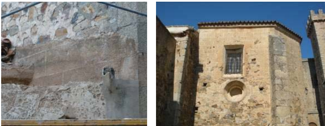
267. Diferentes ejemplos de esgrafiados en Cáceres: a la izquierda detalle de la fachada exterior de la Ermita de la Soledad. A la derecha, esgrafiado deteriorado del convento de San Pablo (MJT).
