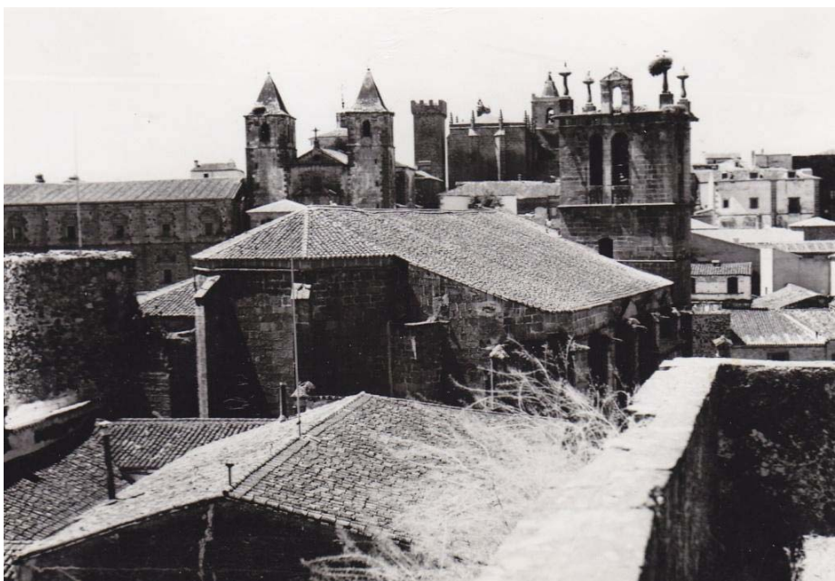
10. Estado de la cubierta de Santa María tras el arreglo de la cabecera en 1950. Esta configuración no es la actual, pues los dos grandes faldones que cubren las nave central y laterales serán transformados posteriormente (AHMC).
