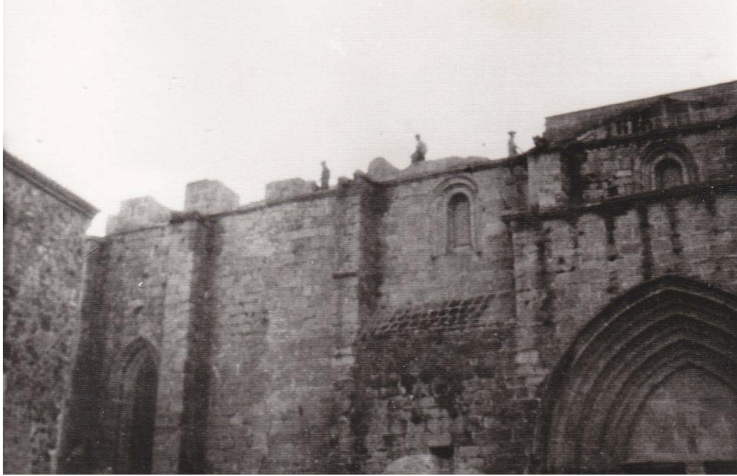
22. Fotografía tomada durante el transcurso de las obras en Santa María, entre 1971 y 1973 (AHMC).
