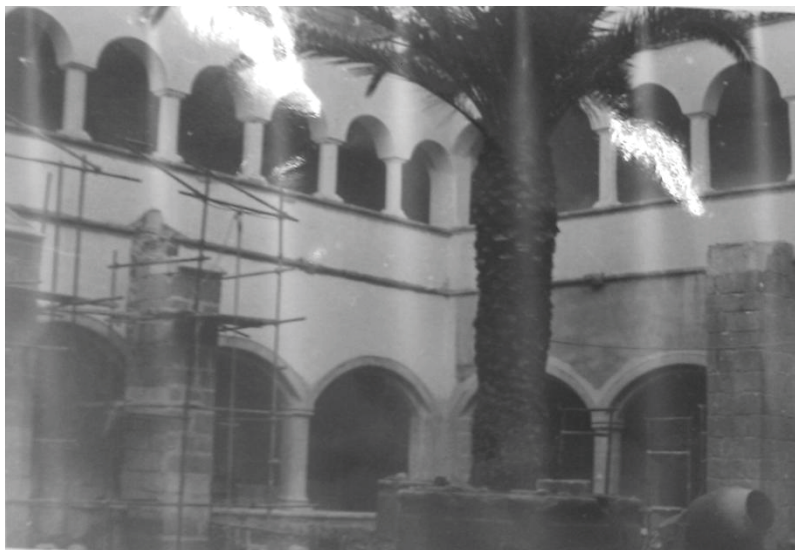
83. Actuación en el claustro Sur del monasterio. Se aprecia la recuperación de la arcada superior mediante la desaparición del contrafuerte añadido (IPCE).
