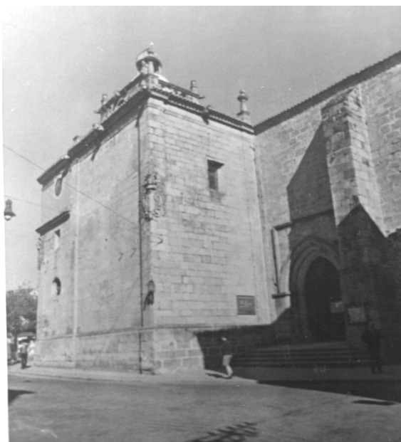
28. Estado de la fachada oriental de la iglesia de San Juan antes de la intervención de 1973 (AHMC).
