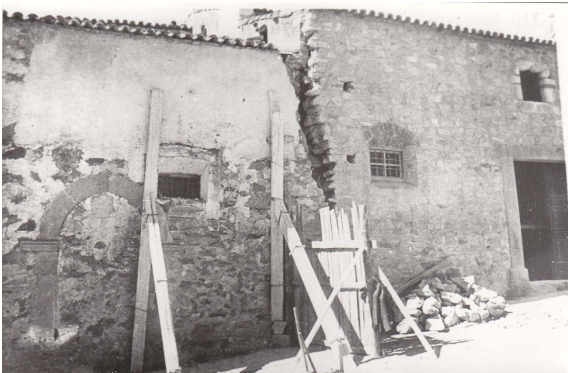
63. Estado del muro de Santa Clara que con seguridad se solicitó intervenir en este proyecto (AHMC, obras).
