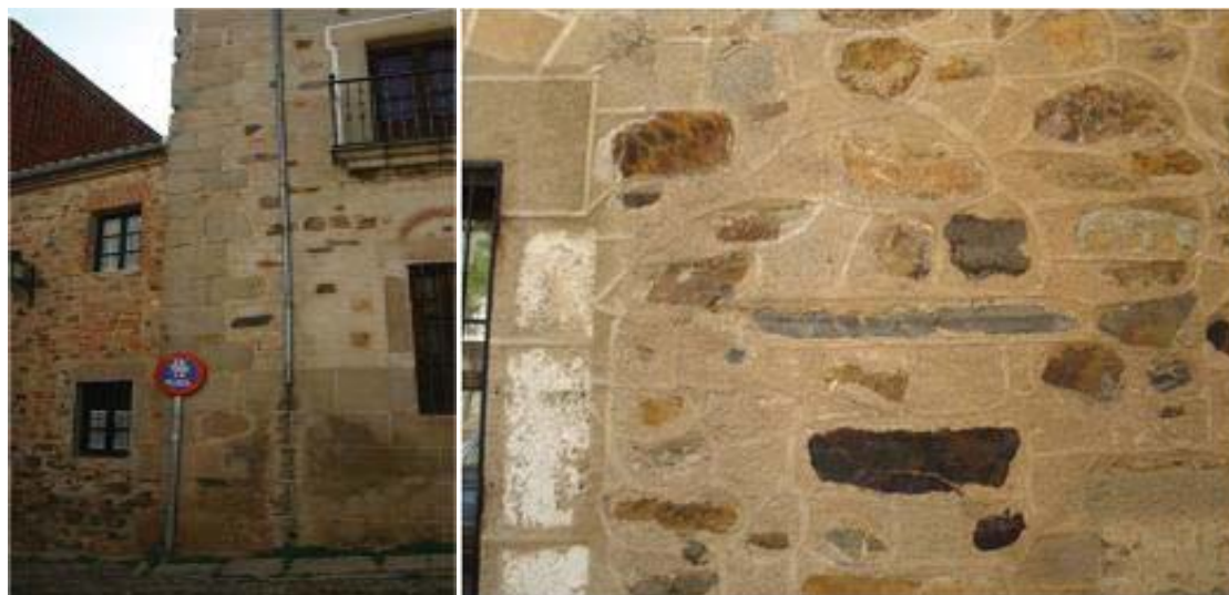
269. Ejemplo moderno de revoco en el que se ha visto reflejada la mala interpretación de los revocos deteriorados (MJT).
