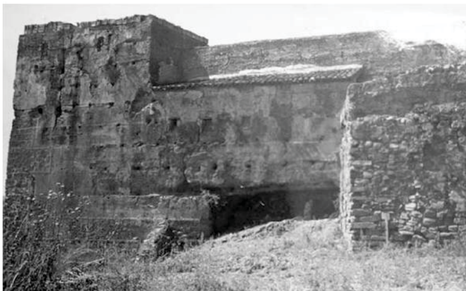
145. Cara norte del baluarte de los Pozos, recogida en el estudio dirigido por Miguel Matas de la muralla de Cáceres. Se observa con claridad el socavón de su base y el mal estado de su revoco exterior (AHMC).
