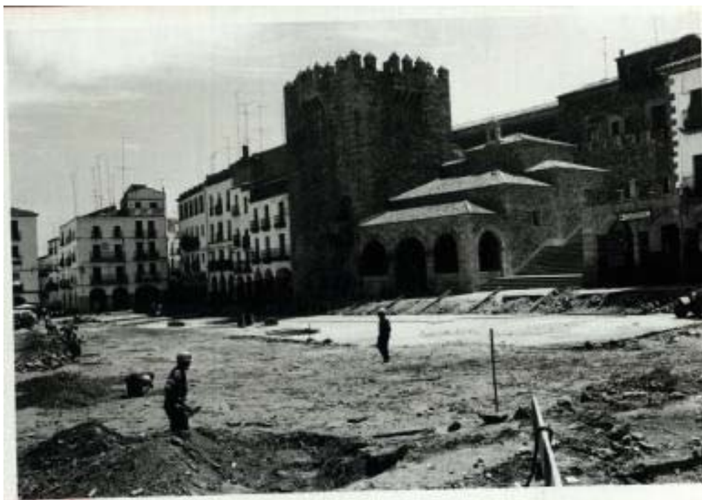
246. Plaza Mayor durante las obras de acondicionamiento de 1970. Es ahora cuando se le concede la configuración que ostentará hasta 2010(AGA).
