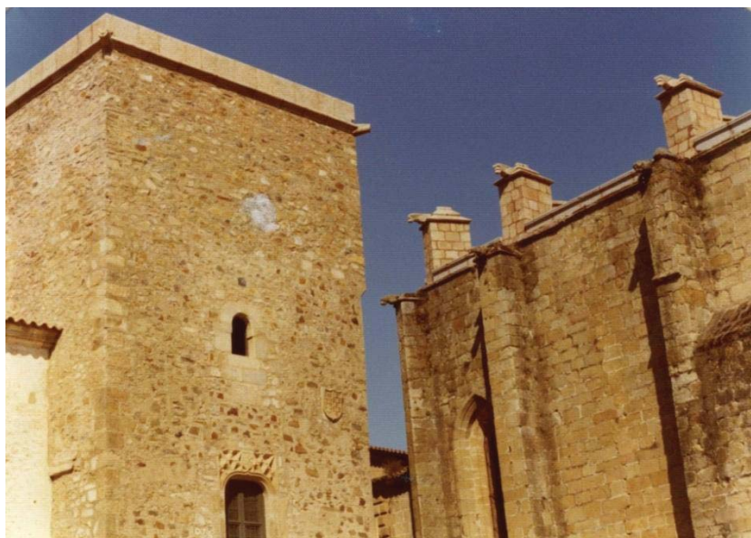
21 Estado de la cubierta tras su intervención. Resulta evidente el cambio de tonalidad de la nueva cantería (AHMC).
