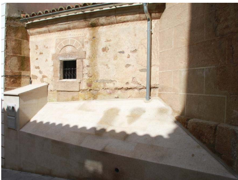
264. Restos de esgrafiados aparecidos en la ermita de la Soledad. Exteriormente apreciamos tres tipos de revoco –muro izquierdo, paramento central y exterior del ábside (MJT).
