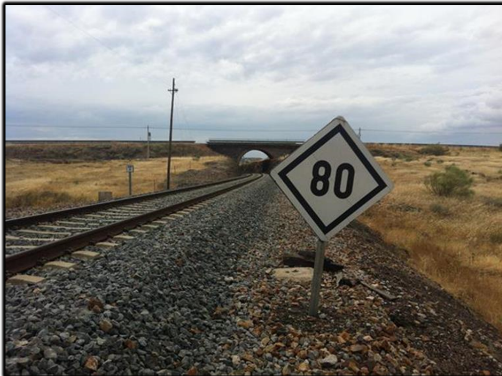
Fotografía 5. Limitación de 80 km/h en el PK 361/400 cerca de Campanario.
