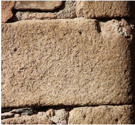
Figura 25: Detalle sillar granito erosionado
