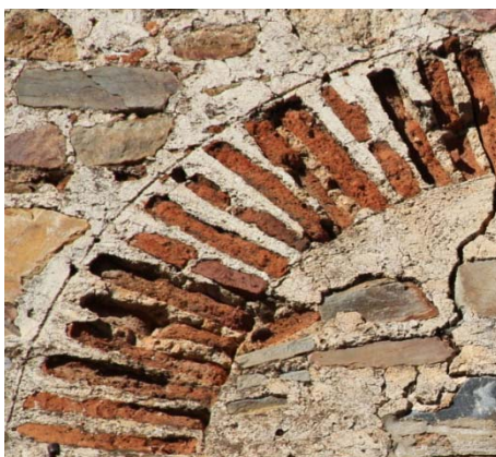
Figura 15: Detalle fábrica de ladrillo erosionada
