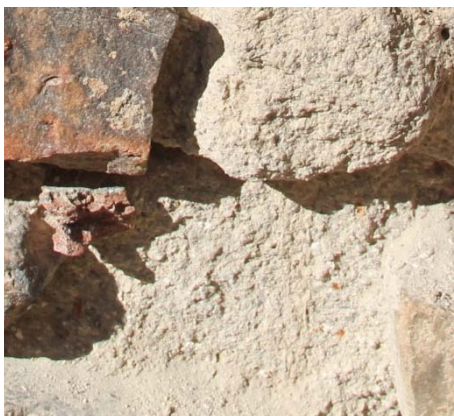
Figura 21: Detalle mortero de cal degradado
