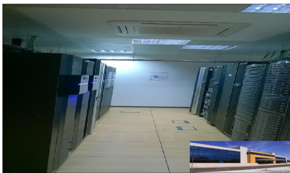
Figura 4.3. Centro de respaldo. Instalaciones FEVAL. Don Benito.
