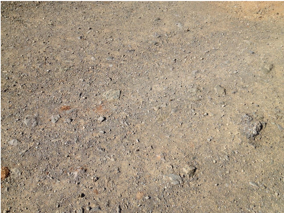
Fotografía 15 – Detalle del estado del camino agrícola
