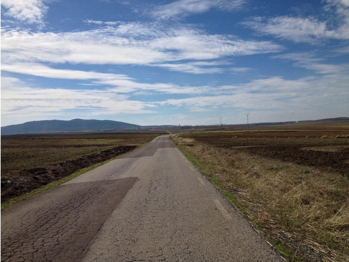
Fotografía 5 – Tramo de la carretera del embalse donde el firme presenta más patologías
