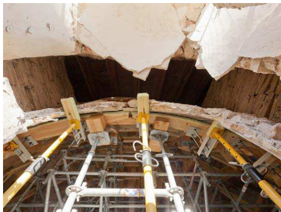
Figura 337. Apeo de la cúpula. En el hueco de la rotura se aprecian los daños, el arranque, y su desarrollo entre dos diafragmas. Foto del autor.
