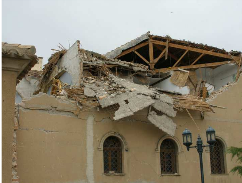
Figura 131. Daños en el muro lateral de la iglesia del Convento de las Clarisas de Lorca.
