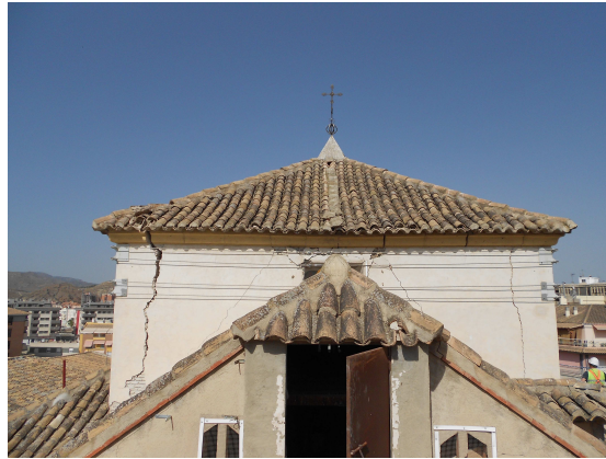
Figura 363. El agrietamiento del cimborrio continuaba por los muros exteriores. Foto del autor.
