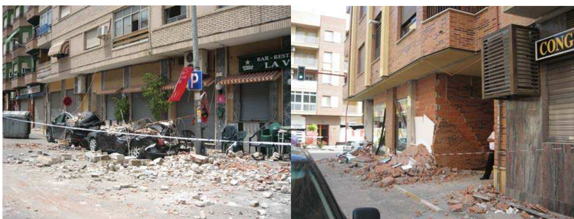
Figura 8. Caída de grandes tramos de antepechos (Izquierda) y de revestimientos (Derecha) (Feriche et al. 2012).
