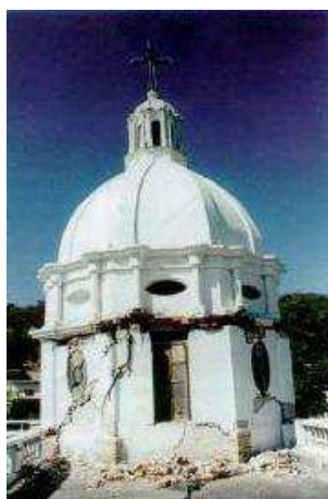
Figura 355. Daños en el tambor de la cúpula. Templo de la Santa Cruz en Cihuatlán, Jalisco.
