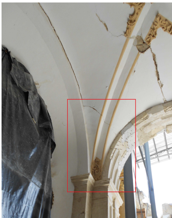
Figura 313. Daños en la iglesia de Santiago. Foto del autor.
