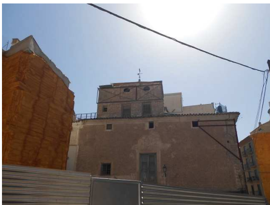
Figura 133. Vuelco de esquina en edificio de Lorca. Foto del autor.
