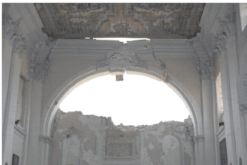
Figura 200. Daños en el arco de la iglesia de los Santos Marciano y Nicandro por el terremoto de L'Aquila.
