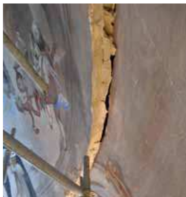
Figura 341. Se aprecia la fractura que experimentó la cúpula, así como el desplazamiento y rotación de cada uno de sus lados
