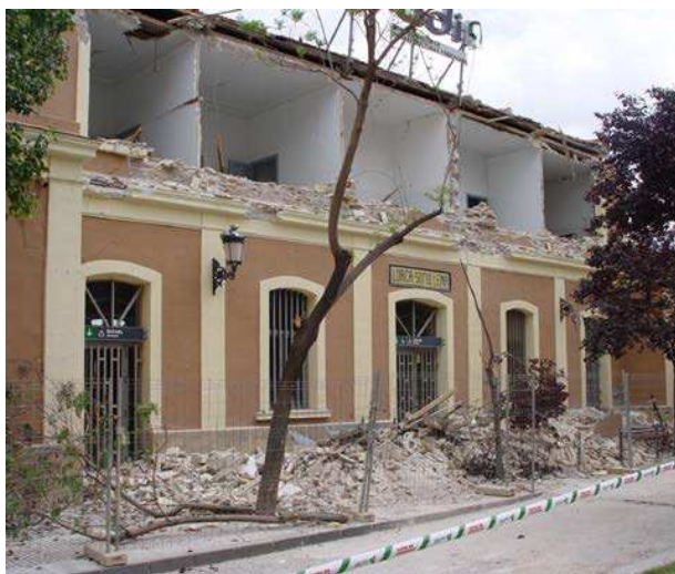
Figura 6. Desprendimiento del muro de la planta superior de la estación de tren de Lorca.
