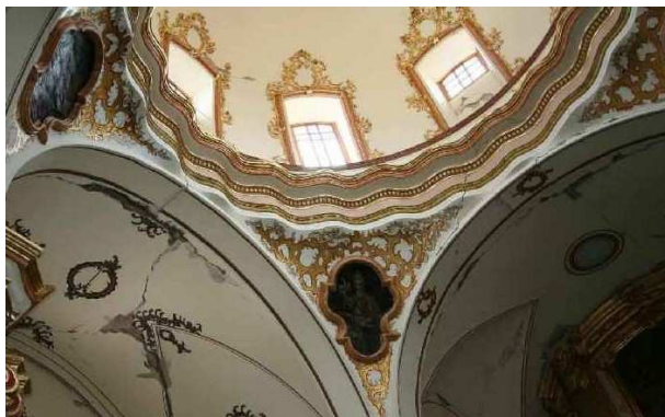
Figura 359. Cúpula de la iglesia de Ntra. Sra. del Carmen con agrietamiento entre los vanos del tambor.
