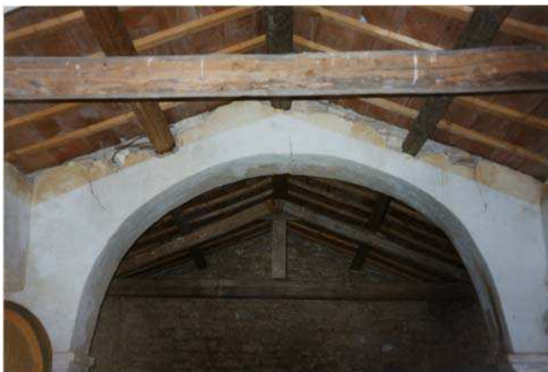
Figura 223. Daños en el arco de la iglesia de San Giovanni en Fabriano.
