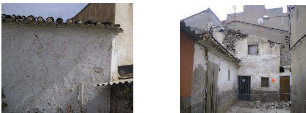
Figura 16. Daños en las estructuras de fábrica (Carreño et al., 2012).
