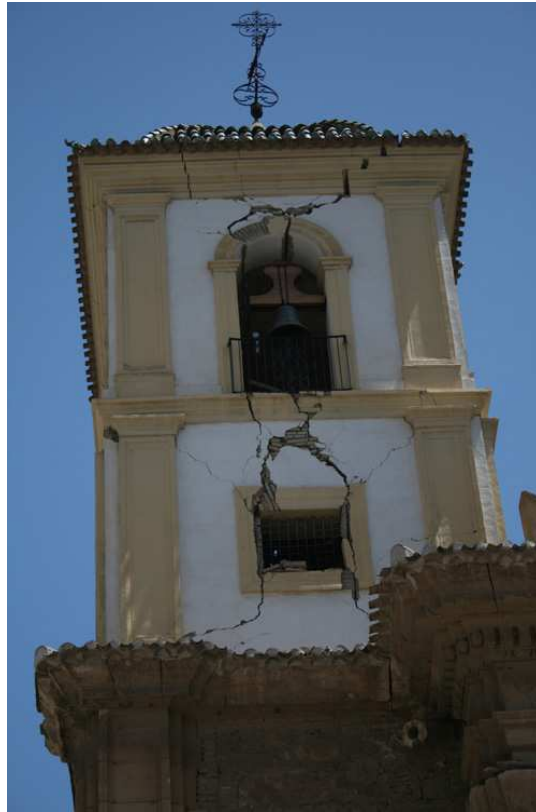
Figura 162. Grietas en la torre de la iglesia de Santiago.
