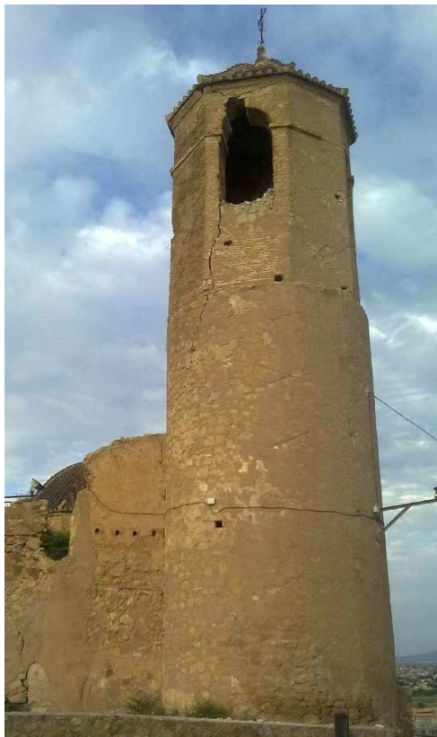
Figura 167. Grietas en la torre de la iglesia de San Juan.
