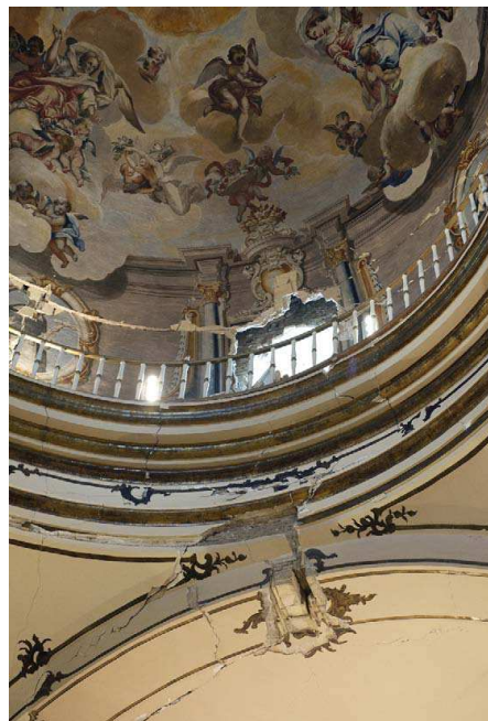
Figura 339. Aspecto de la cúpula por su interior, en el que se comprueba su seccionamiento, el agrietamiento del tambor y el desplazamiento de la clave del arco.
