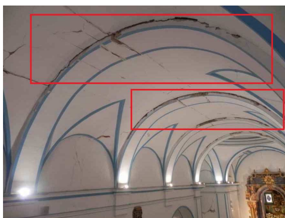
Figura 271. Grietas en la nave central de la Iglesia de San Diego de Lorca.
