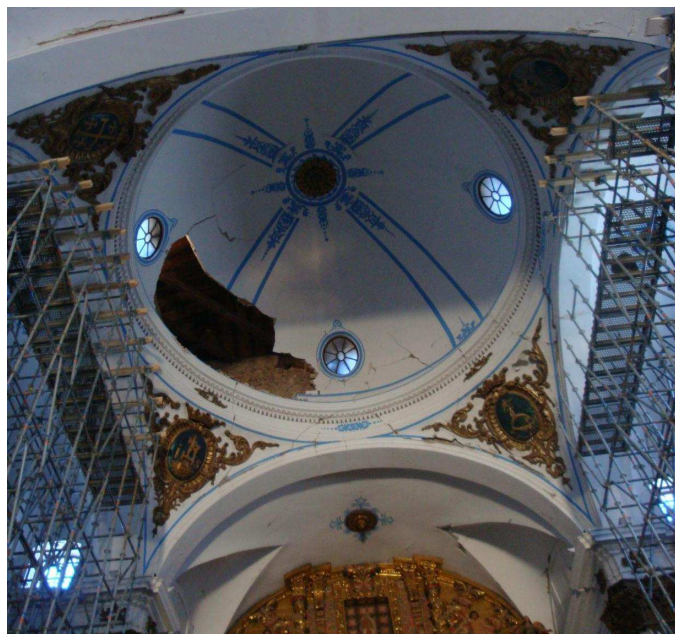
Figura 323. Rotura de la cúpula de la Iglesia de San Francisco con pérdida de parte de la cúpula tabicada.
