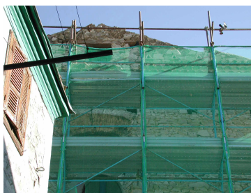
Figura 48. Desplome en el ábside. (Lagomarsino et al., 2004).
