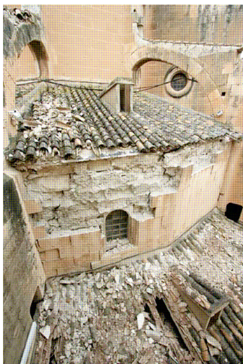
Figura 19. Desplome de la cara exterior del muro de la girola de la Colegiata de San Patricio sobre las cubiertas.
