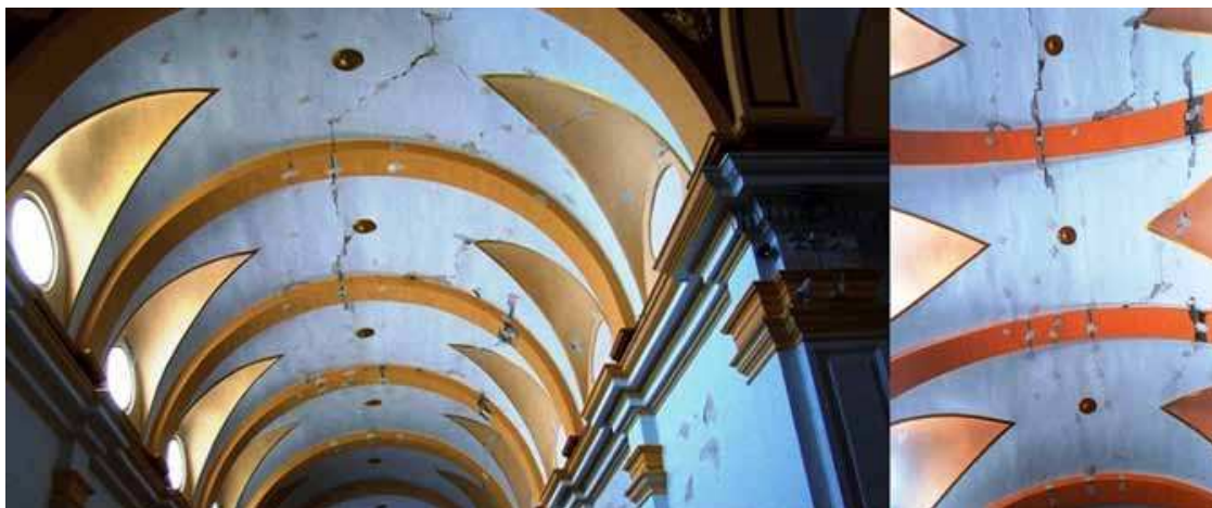
Figura 281. Lesiones en arcos y bóveda de la nave central.
