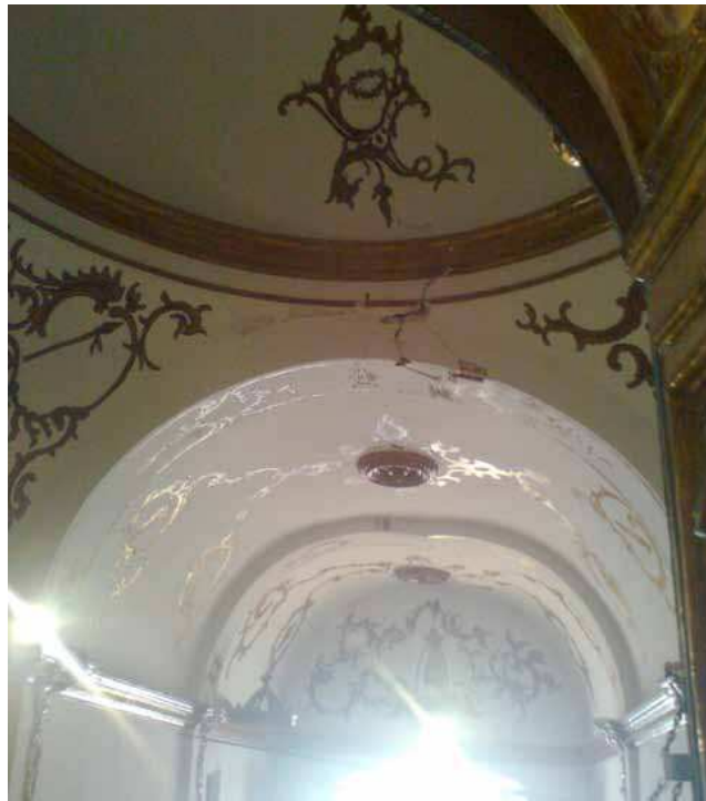
Figura 300. Aspecto que presentaban los arcos fajones y la bóveda tras producirse rotura por la clave.
