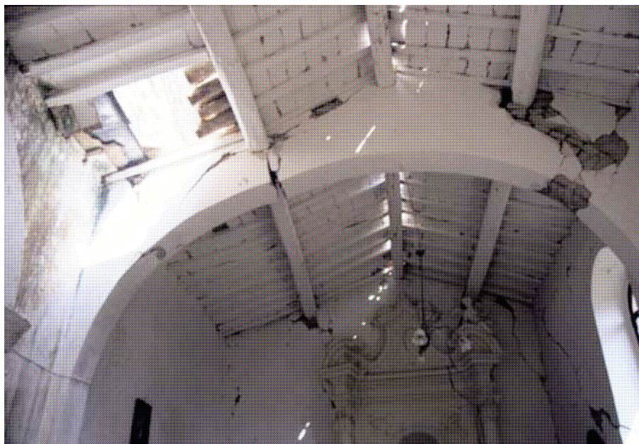
Figura 214. Daños en el arco de la iglesia de San María della Presentazione.
