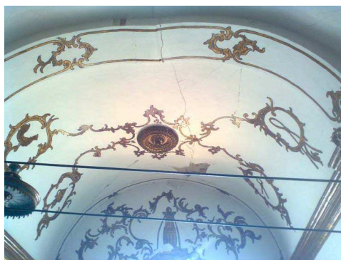
Figura 72. Daños en la bóveda (Peñalver, 2013).
