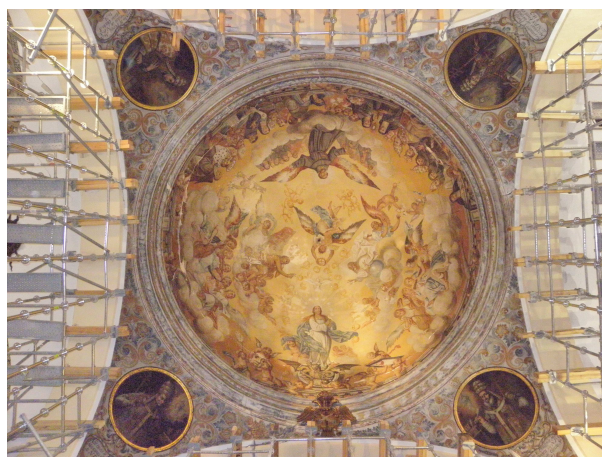
Figura 334. Agrietamiento horizontal de la cúpula de la Iglesia Virgen de las Huertas.
