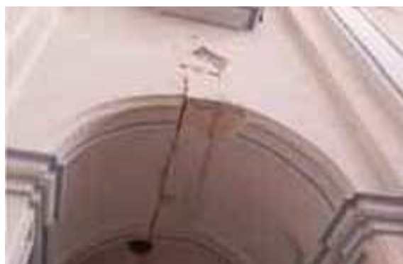
Figura 285. Grietas en la capilla lateral.
