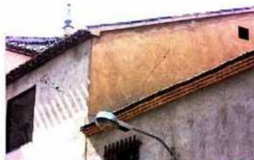
fisuración esquina fachada crucero (cuña)
