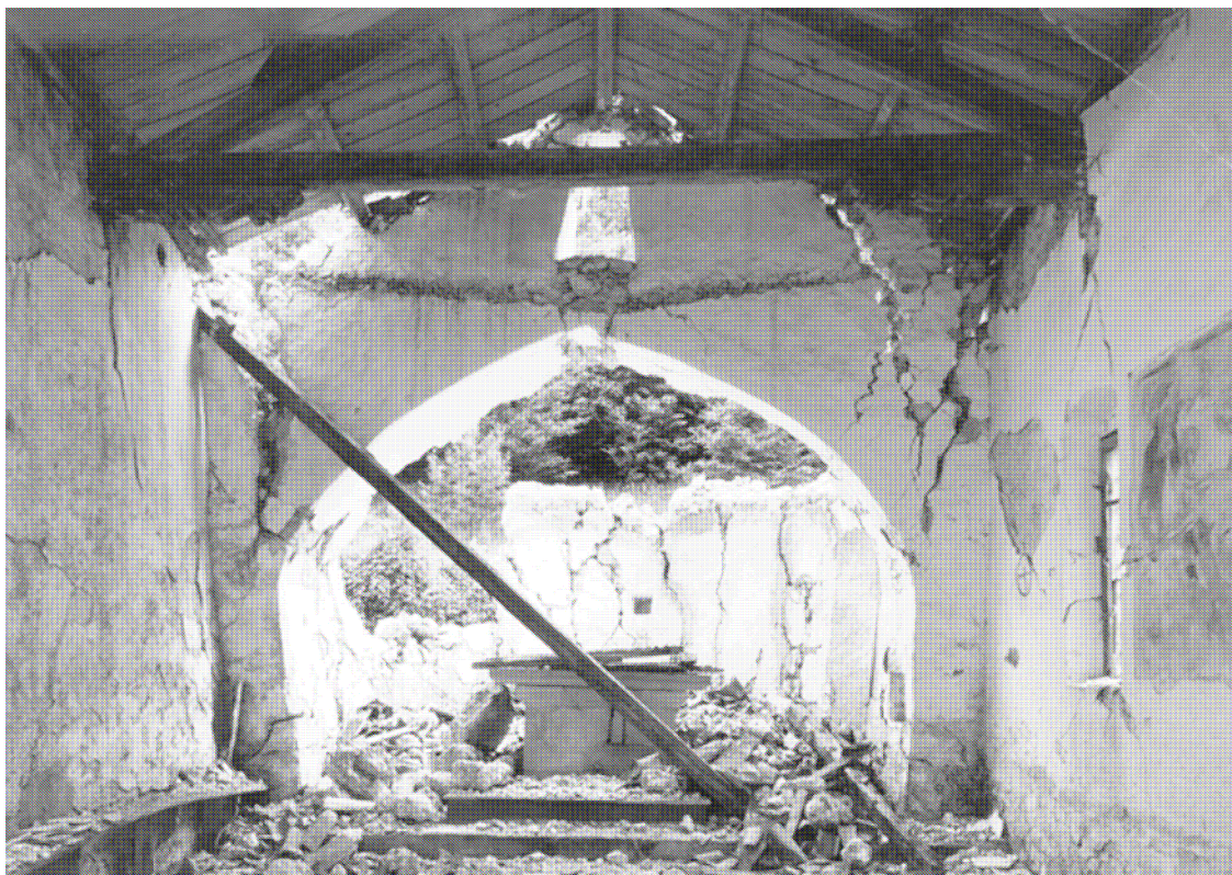
Figura 222. Daños en el arco de la iglesia de Santa Caterina en Venzone.
