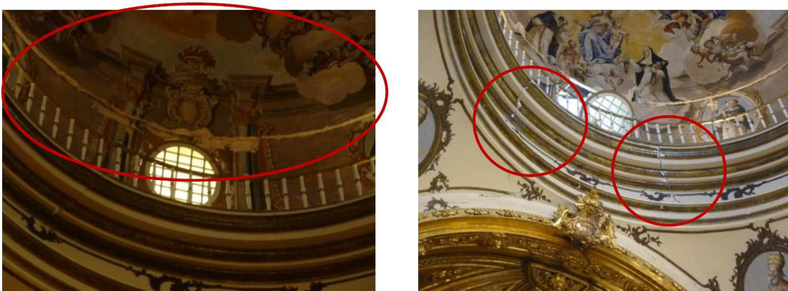
Figura 338. Línea de fractura en la cúpula.
