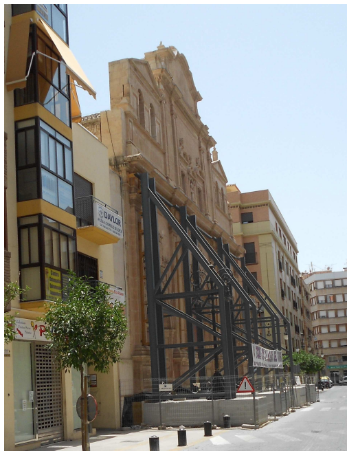
Figura 101. Fachada de la iglesia de Nuestra Señora del Carmen de Lorca. Foto del autor.
