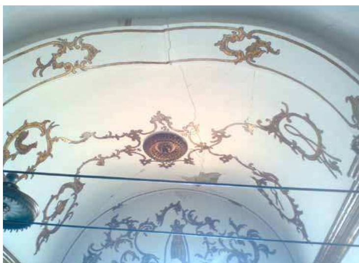
Figura 299. Estado de fisuración de la bóveda
