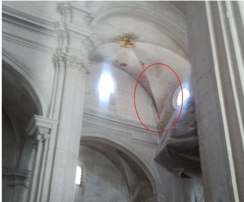
Figura 314. Daño en la bóveda de la Colegiata de San Patricio. Foto del autor.
