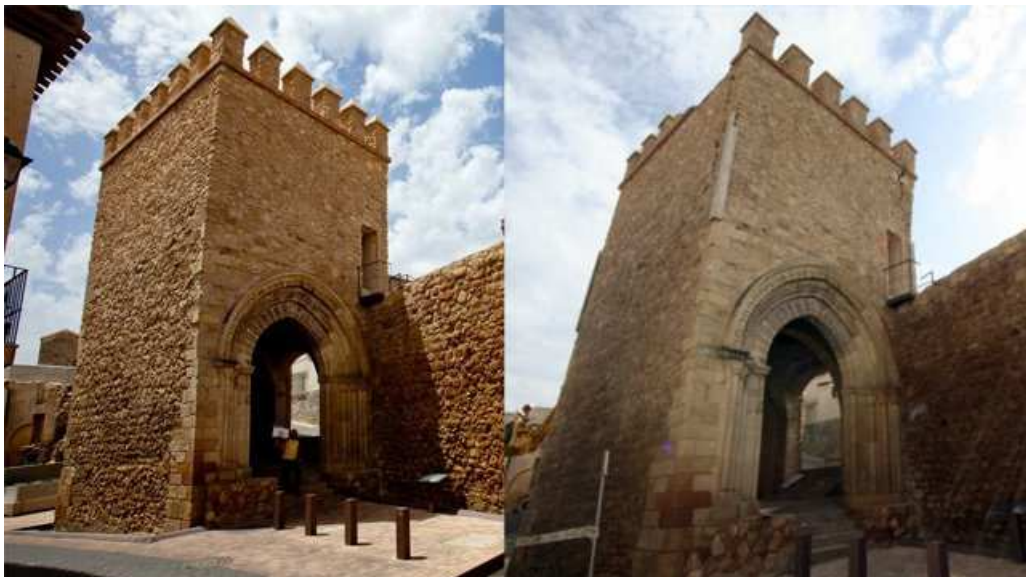
Figura 77. Daños en el Porche de San Antonio.
