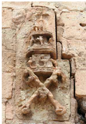
Figura 120. Iglesia de San Pedro. Vuelco de la hoja exterior en sillería del muro de la fachada principal con juntas de sillares abiertas en el encuentro con la portada gótica.
