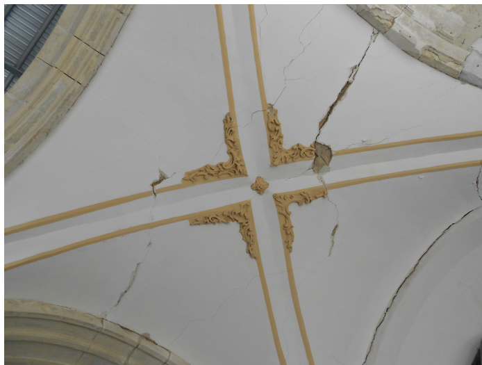
Figura 292. Daños en la iglesia de Santiago. Foto del autor.
