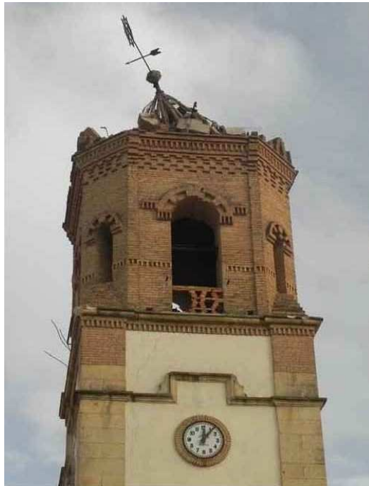
Figura 168. Grietas en la torre de Santa María la Real de las Huertas
