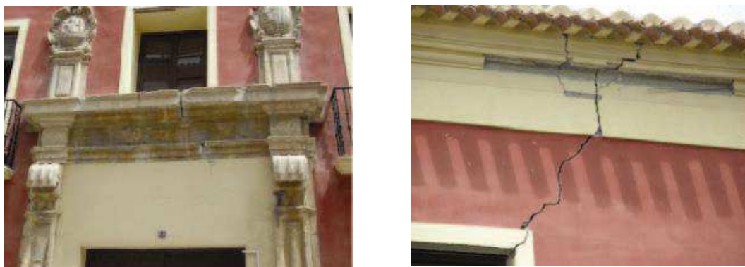
Figura 15. Daños en las estructuras de fábrica (Carreño et al., 2012).
