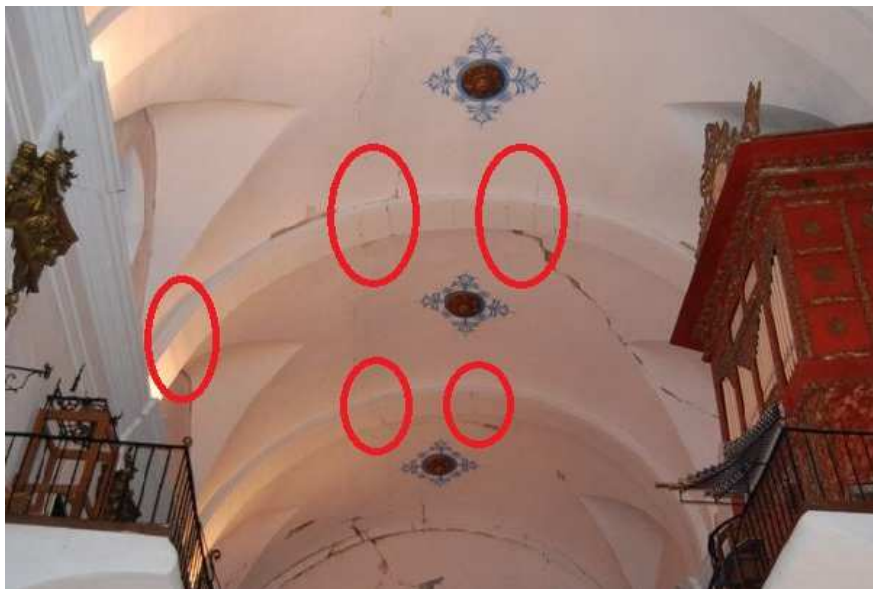
Figura 229. Daños en arcos de la iglesia de San Francisco de Lorca.
