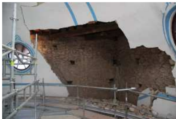
Figura 324. Detalle de la rotura de la cúpula.
