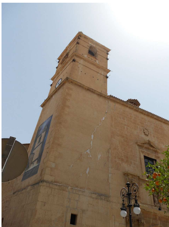
Figura 172. Separación de la torre de la iglesia de San Francisco. Foto del autor.
