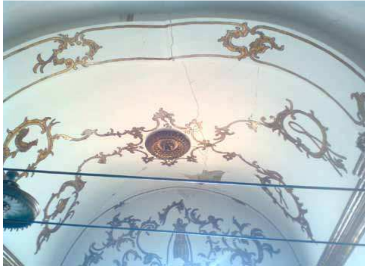
Figura 231. Daños en arco de la ermita del Calvario.
