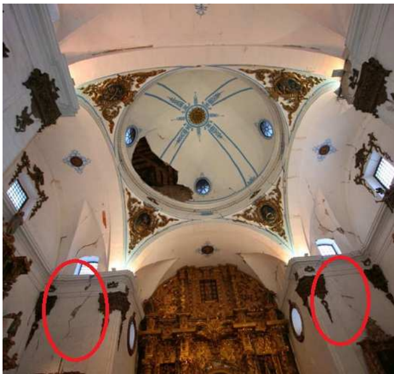
Figura 239. Daños en los apoyos del arco de la iglesia de San Francisco de Lorca.
