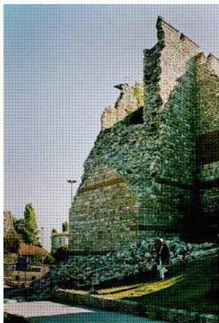
Figura 35. Torre reconstruida y colapsada. (Langenbach, 2004).
