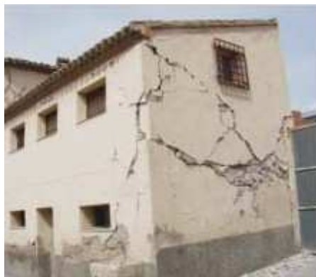
Figura 11. Grietas en forma de cruz. Convento de las Clarisas de Lorca.
