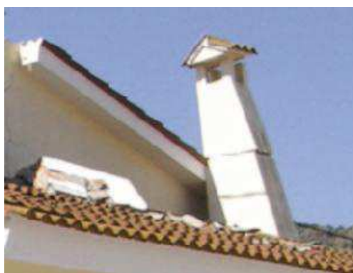
Figura 10. Chimenea dañada por el terremoto en casa residencial (Carreño et al., 2012).
