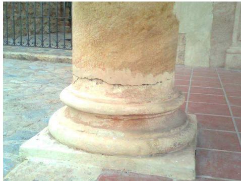
Figura 13. Agrietamiento por flexión. Ermita del Calvario de Lorca.
