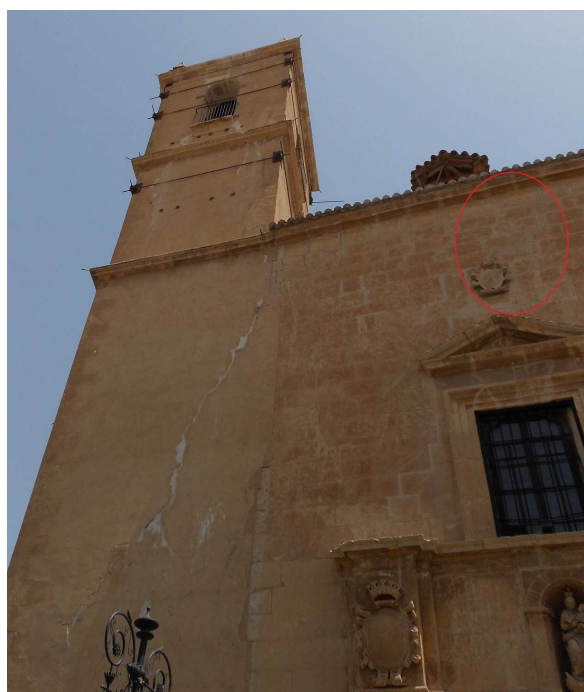
Figura 122. Daño en la fachada de la iglesia de San Francisco. Foto del autor.
