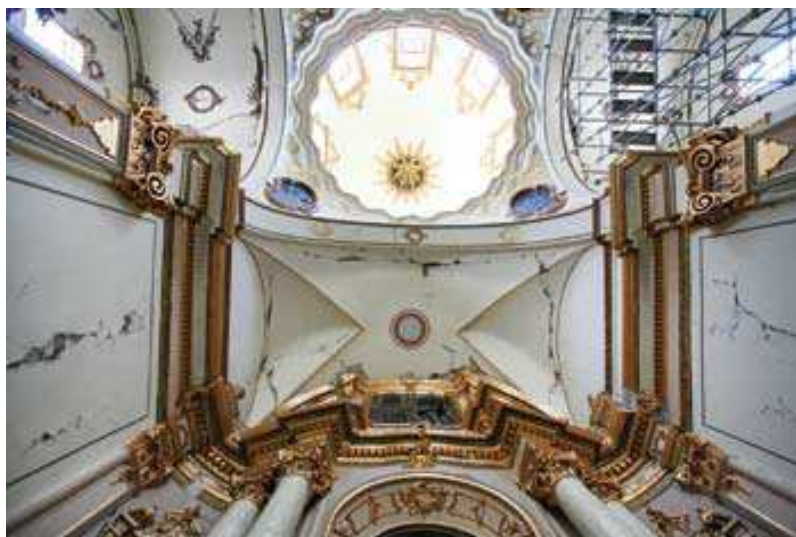
Figura 273. Grietas en bóvedas del crucero. Iglesia Ntra. Sra. del Carmen de Lorca
