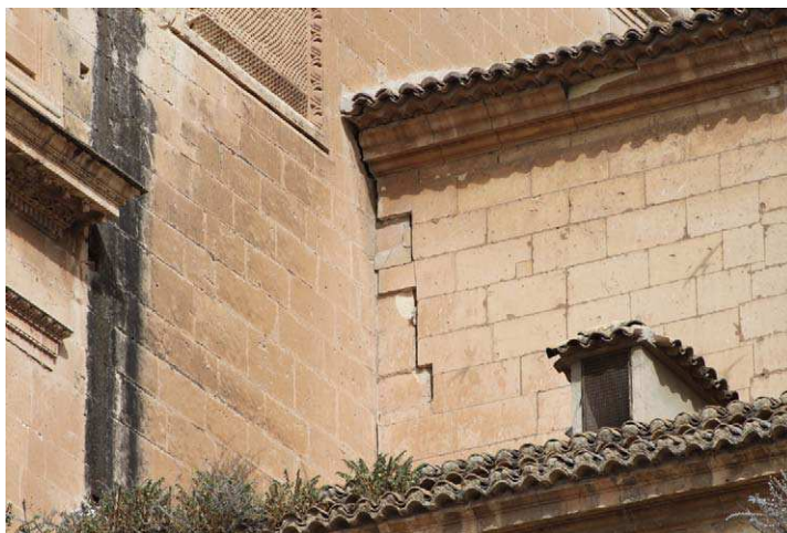
Figura 107. Detalles de la fachada lateral sur de la Colegiata de San Patricio, en el encuentro con la fachada principal.
