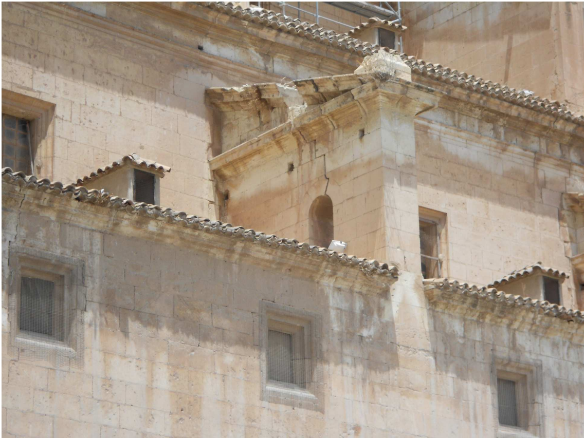
Figura 217. Daño en arco en la Colegiata de San Patricio. Foto del autor.
