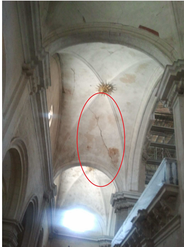
Figura 307. Daño en la bóveda de la Colegiata de San Patricio. Foto del autor.
