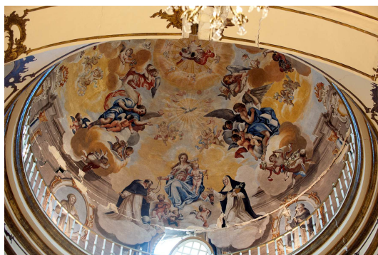
Figura 70. Daños en la Cúpula del Rosario. Fuente Juan Carlos Cartagena
