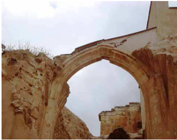
Figura 263. Clave extruida en la iglesia de Santa María como consecuencia del terremoto del 11 de mayo de 2011
