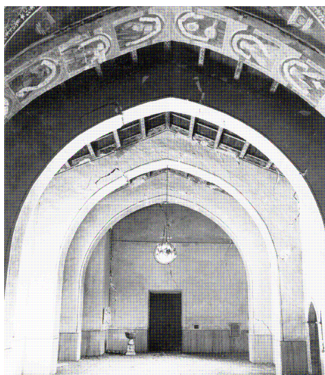
Figura 233. Daños en el arco de la iglesia de Santa María Assunta
