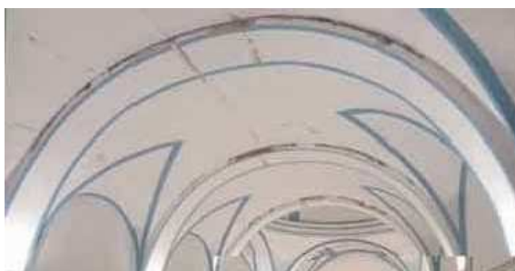
Figura 74. Daños en la nave central de la Iglesia de San Diego de Lorca
