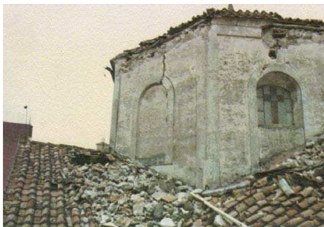
Figura 361. Agrietamiento vertical del cimborrio.
