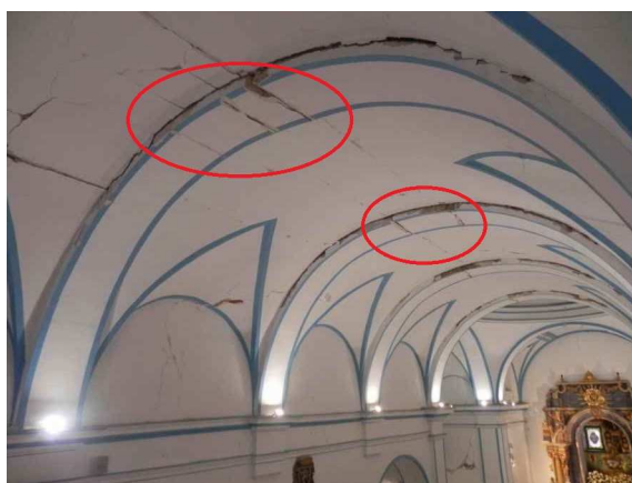
Figura 228. Daños en arcos en la iglesia de San Diego de Lorca.
