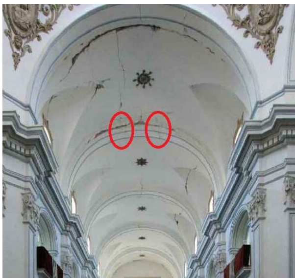
Figura 227. Daños en arcos en la iglesia de San Mateo de Lorca.
