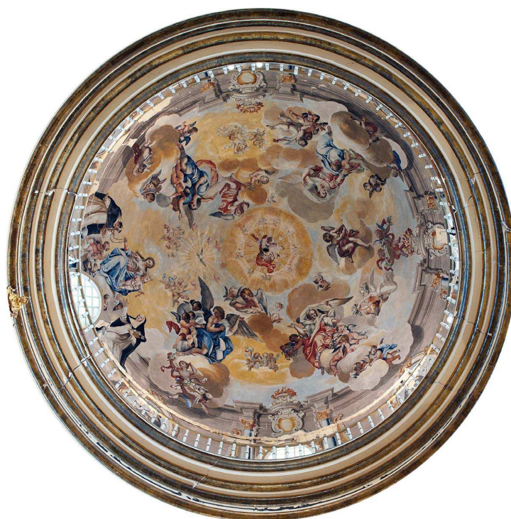
Figura 340. Imagen del intradós de la Cúpula donde se aprecia la singularidad de las pinturas y los daños producidos
