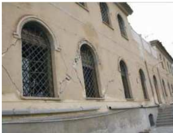
Figura 12. Grietas formadas por tensión diagonal entre las ventanas de un edificio de fábrica. Convento de las Clarisas de Lorca.
