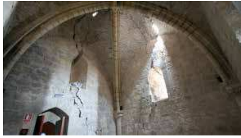
Figura 134. Torre del Espolón de Lorca. Expulsión de la esquina con arrastre de bóveda.
