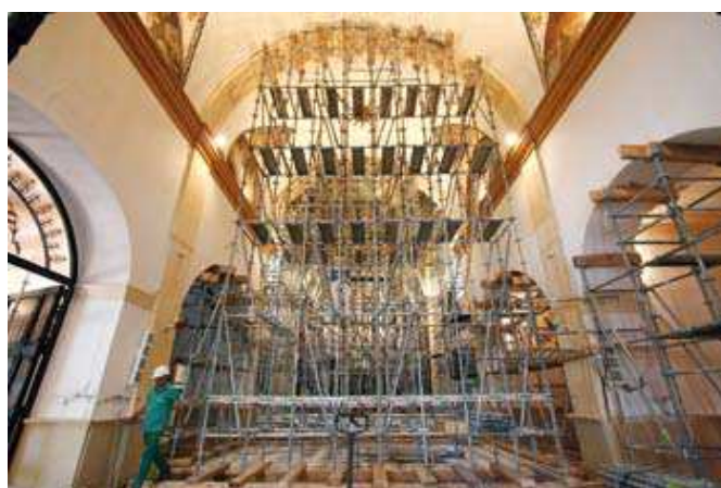
Figura 295. Apeo de los arcos fajones de la nave central de la Iglesia de Virgen de las Huertas.
