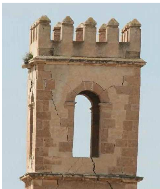
Figura 181. Grietas en el campanario de la iglesia de San Pedro.
