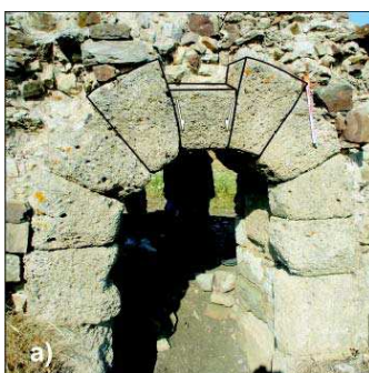
Figura 260. Caída de la clave de un arco en la puerta de uno de los bastiones de la muralla de la ciudad
