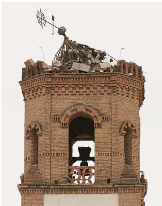
Figura 75. Desplome de la estructura de hormigón del cupulín de la torre de la Iglesia Virgen de las Huertas.
