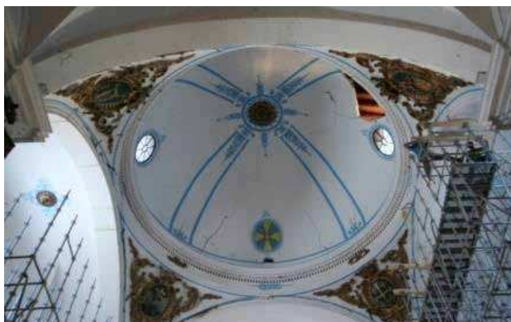
Figura 325. Imagen de la iglesia de San Francisco con grietas verticales.
