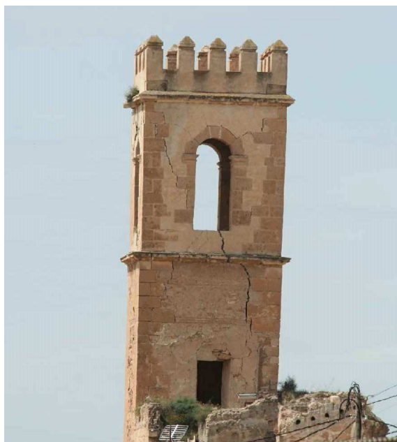
Figura 158. Grietas en la torre de la iglesia de San Pedro de Lorca.
