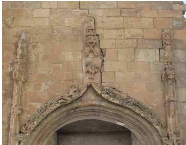
Figura 119. Imagen del acceso con grietas sobre el arco de entrada. Fotografías realizadas el 17 de mayo de 2011.
