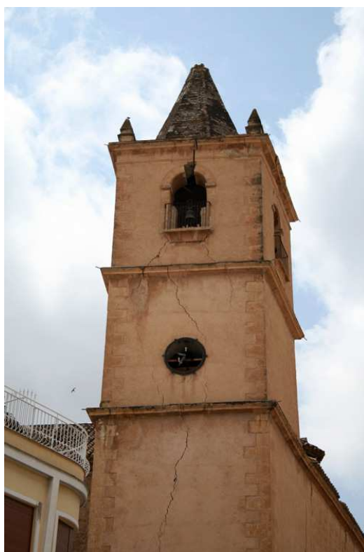
Figura 154. Grietas en la torre de la iglesia de San Francisco.
