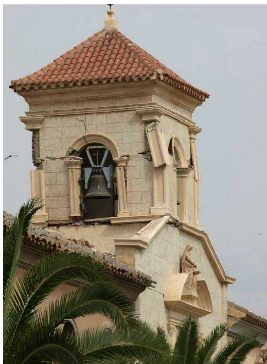
Figura 178. Daños en el campanario de la iglesia del Convento de las Clarisas de Lorca.
