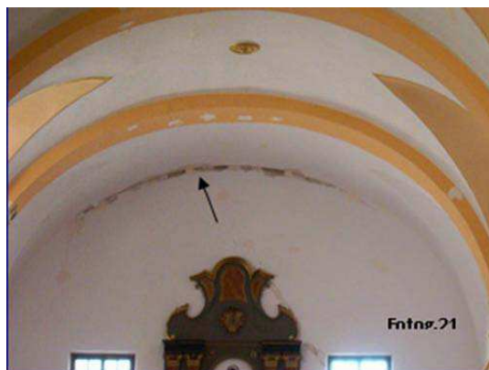
Figura 103. Agrietamiento y separación hacia el exterior del muro de fachada frontal de la nave.
