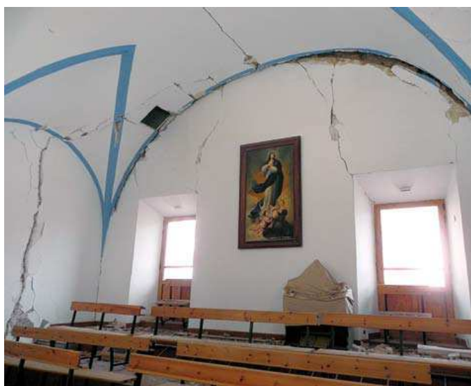
Figura 105. Apertura de una gran grieta entre la bóveda del coro y la fachada de la Iglesia de San Diego en Lorca, como consecuencia del desplazamiento de vuelco hacia el exterior de dicha fachada.
