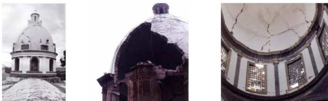
Figura 321. Fallo por cortante en la cúpula
