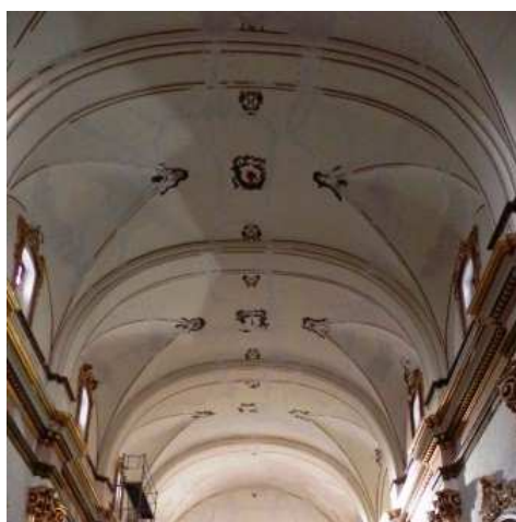
Figura 230. Daños en arcos en la iglesia de Nuestra Señora del Carmen.
