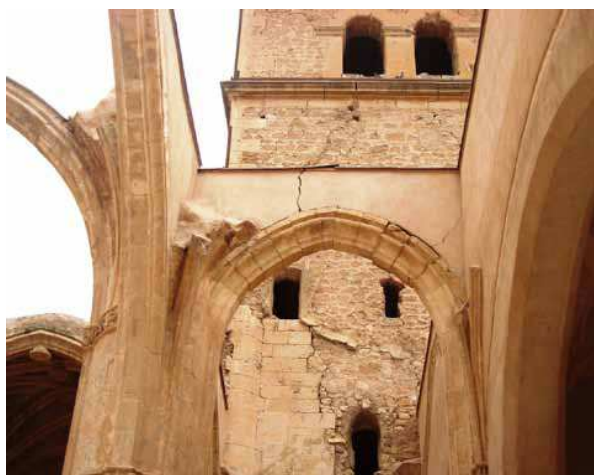
Figura 224. Daños en arcos en la iglesia de Santa María de Lorca.
