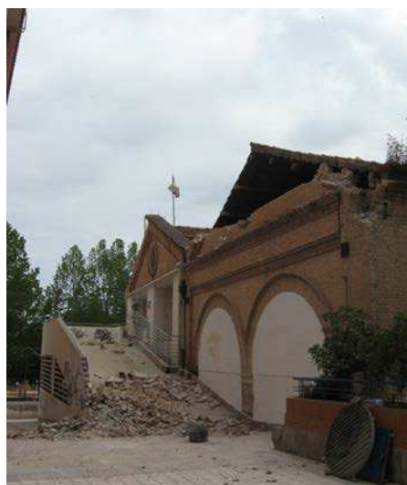
Figura 7. Desprendimiento del muro piñón de la estación de Lorca.
