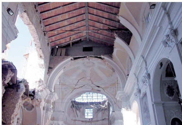
Figura 49. Daños en la Iglesia de San Marco. (Roca, 2011).
