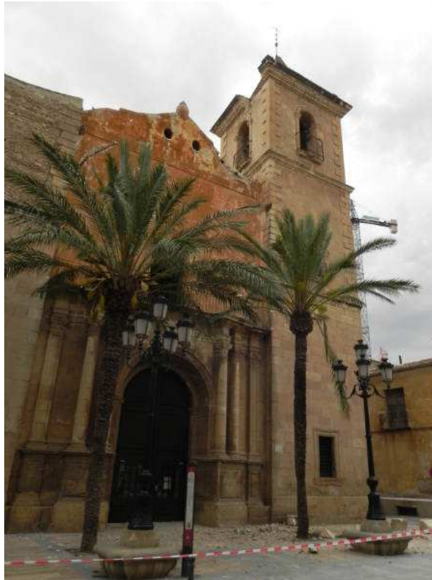
Figura 160. Daños en la torre de la iglesia de San Mateo de Lorca.
