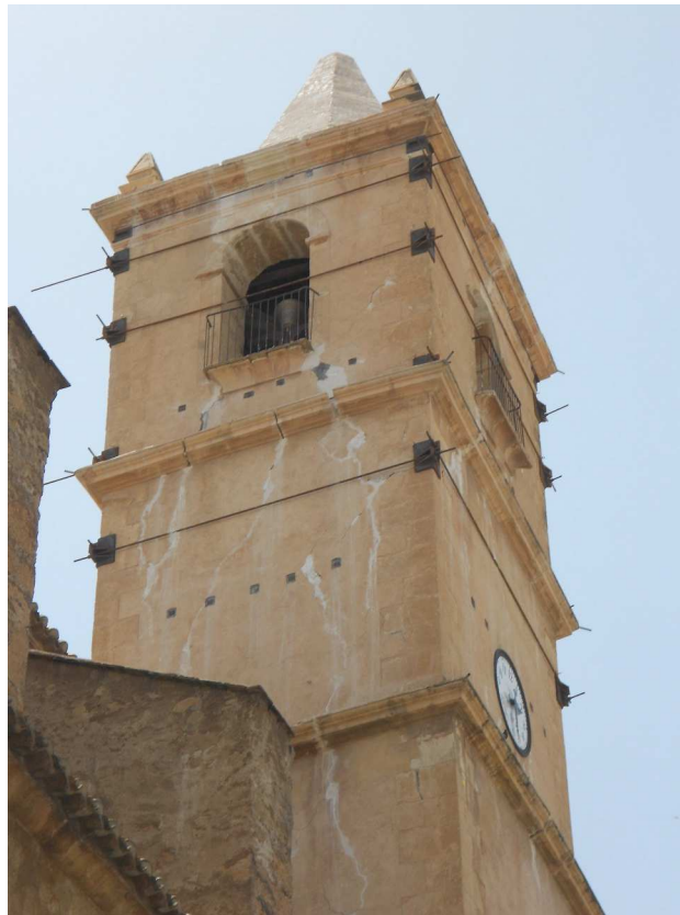
Figura 155. Grietas en la torre de la iglesia de San Francisco. Foto del autor.
