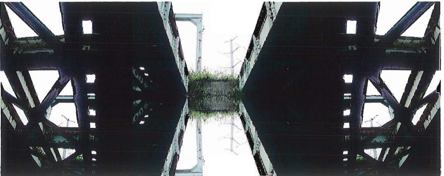
8.40.-8.42. Puente de ferrocarril entre los municipios de Barakaldo y Sestao con estructura de hierro oxidada y en desuso (2006).
