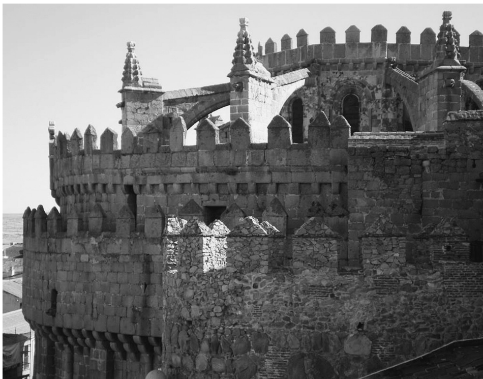
FIG. 3. Triple línea de almenas del cimorro (fotografía: María Estela González de la Granja).
