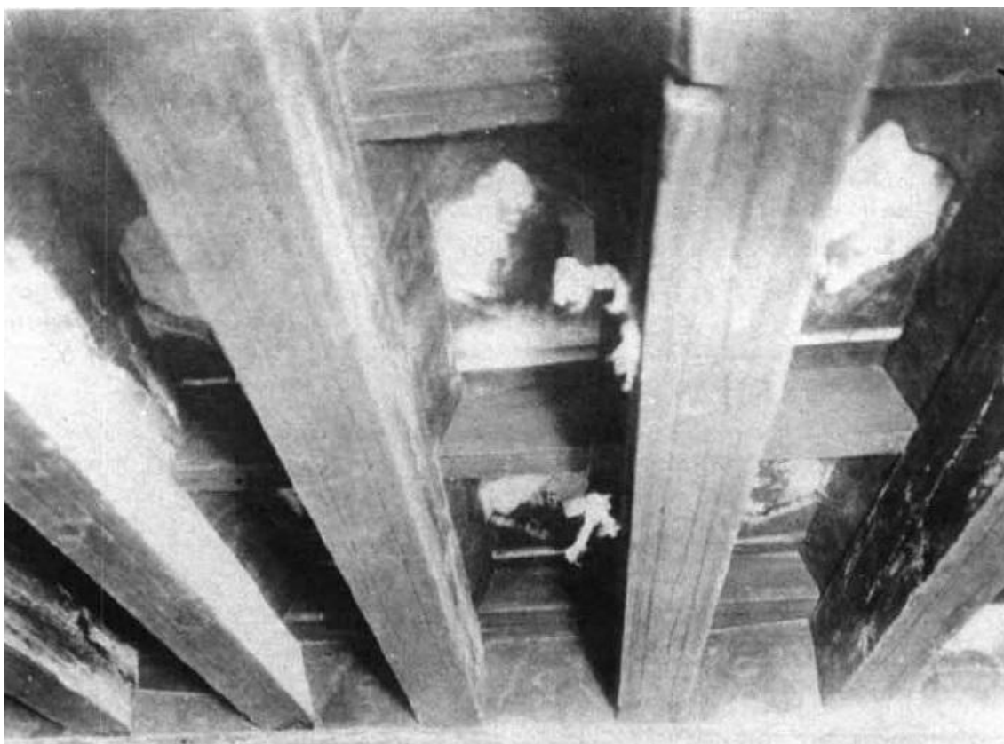
Figura 341. Fotografía de la techumbre de la biblioteca del conventual alcantarino, antes de ser desmontada (Merino de Cáceres, 1987).
