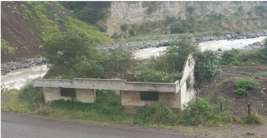
Imagen 3. Vivienda destruida por Lahar, agosto 2006 comunidad Palictahua
