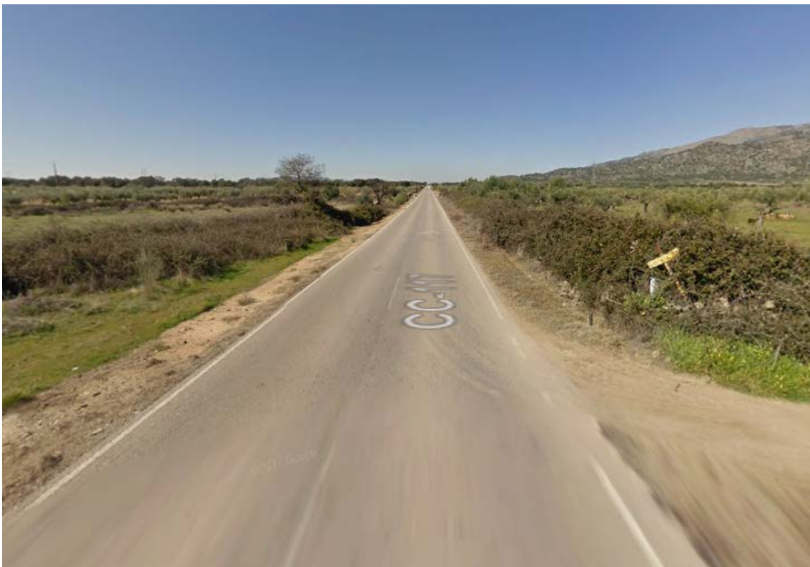
Imagen 3. Estado reducido de los arcenes.
