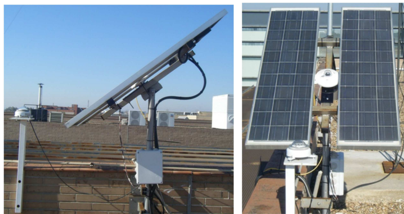
Figura 3.3. Módulos fotovoltaicos y piranómetros.
