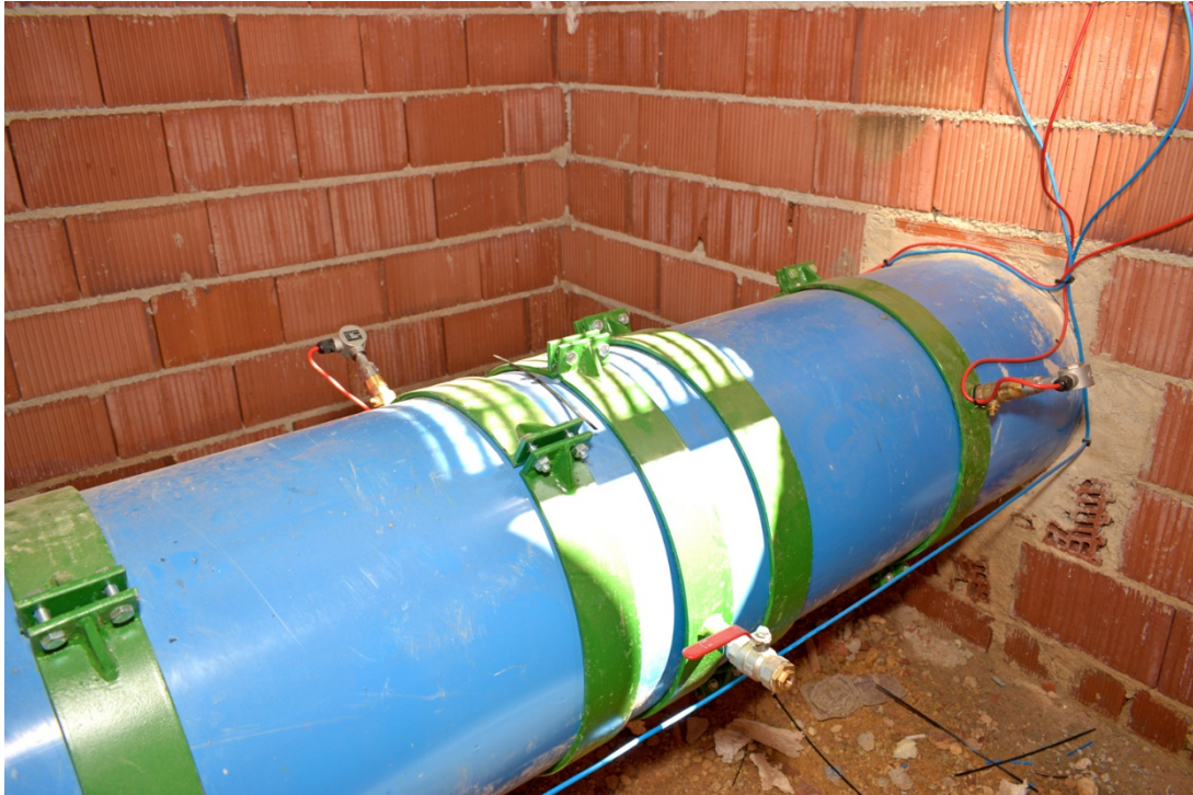
Figura 5: Caudalímetro instalado en colector principal de salida de balsa
