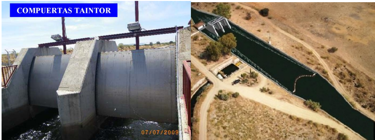
Figura 6. Detalle de una compuerta y vista de un aliviadero de picos de pato.
