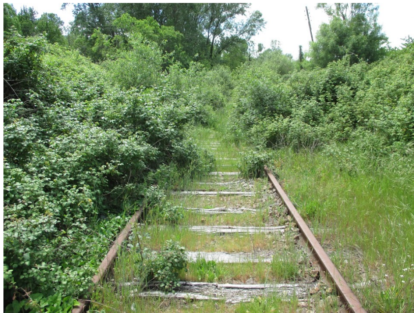
Imagen 7. Ocupación de la vía por parte de la vegetación. Fuente: Google Earth.
