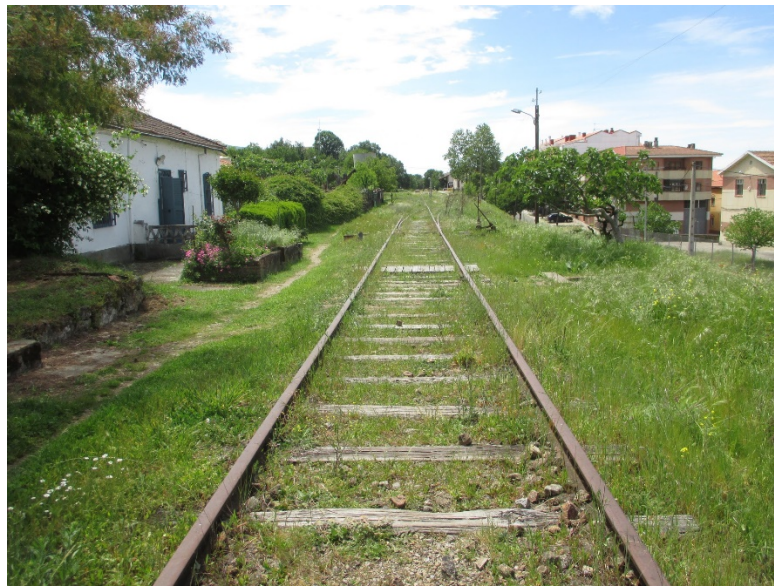
Imagen 5. Estado de la vía a la salida de Hervás. Fuente: Google Earth.
