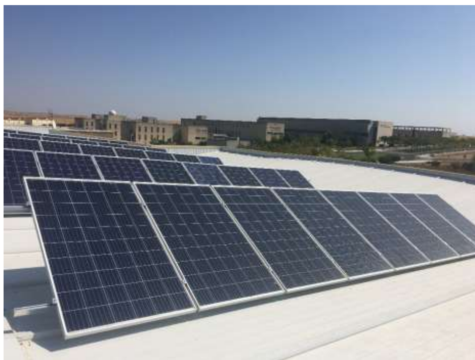
Figura 16: Paneles solares de la EPCC
