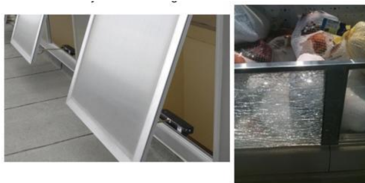
FIGURA 6.23. Ventanas que incumplen Norma IFS. Fuente: SGS (2014)
