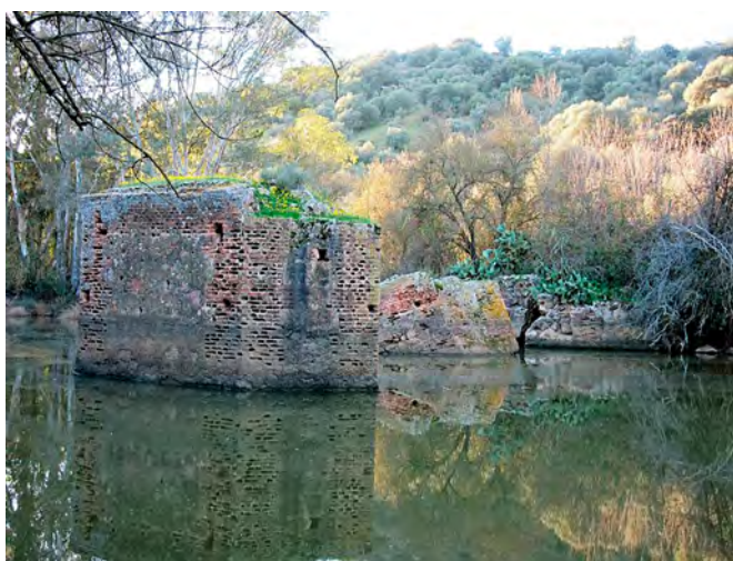
Figura 5. Puente de Siete Vadillos en La Zarza, estado actual. Fotografía de Fabián Lavado Rodríguez.
