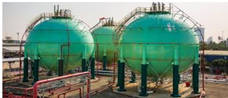
Figura 6. Tanque de almacenamiento de hidrógeno en estado gaseoso. Fuente: Ariema
