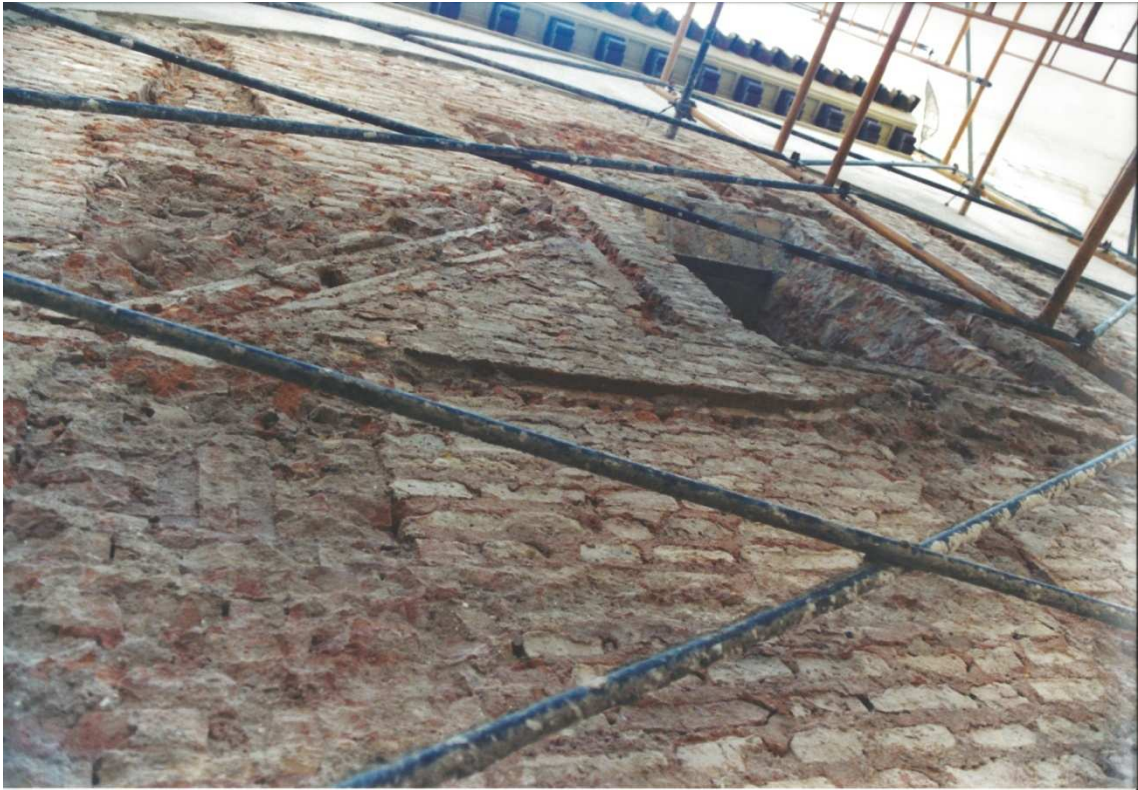
Fotografía 19. Imagen mostrando una de las fases de actuación en la fachada Sur.
