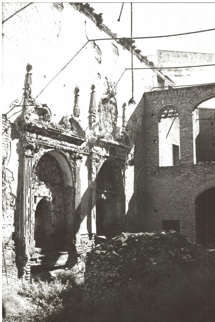
Fotografía 3. Muro interior orientación Este y Sur. Observar el abandono sufrido después de la destrucción el 23 junio 1936. Extraída de los archivos, de la Biblioteca Nacional de Madrid.
