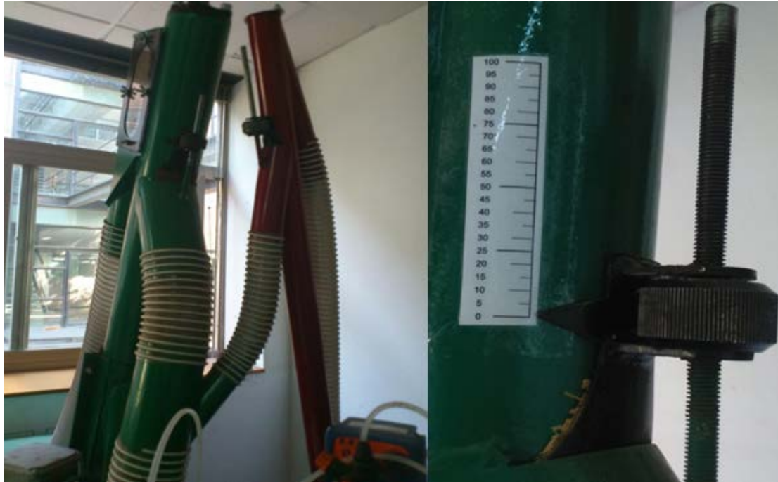
Figura 3.5 Compuerta reguladora de caudal.
