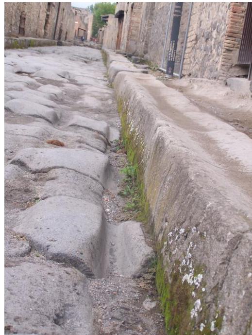
Foto136: Canales de agua residual en la calle. Pompeya. Fuente: M. Fraile.
