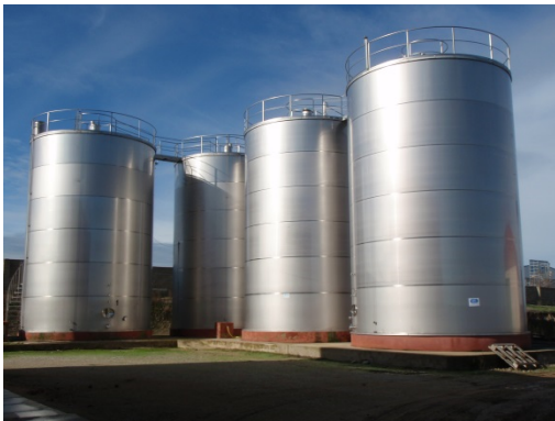
Depósitos de almacenamiento.
