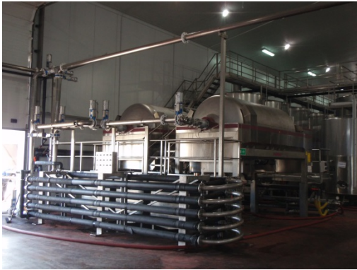
Prensas neumáticas e intercambiador.
