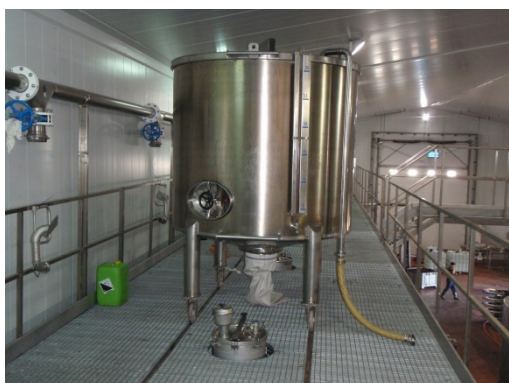
Depósito auxiliar para remontado(Sistema OVIS).
