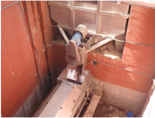
Salida de descarga a despalladora.
