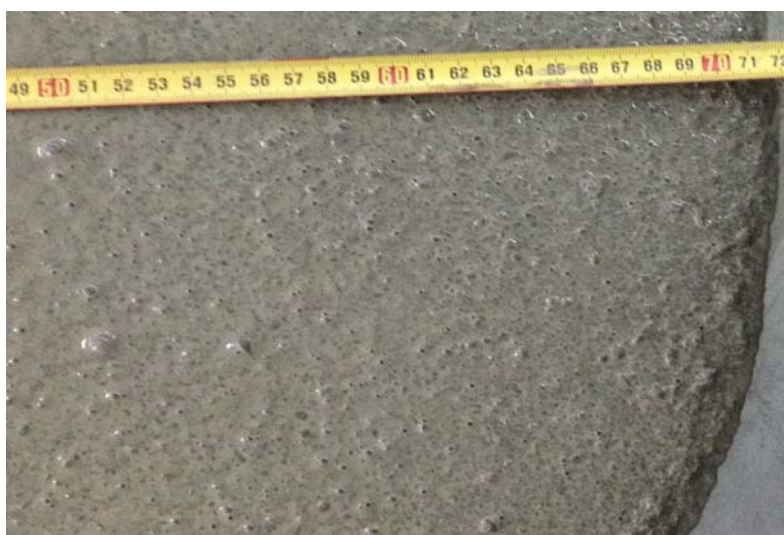
Figura 3.33 Presencia de burbujas superficiales.
