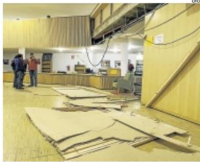
Los materiales desprendidos de la terraza superior.
