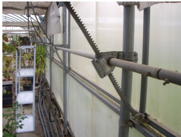
Figura 24. Automatismo para la ventilación lateral. (Fuente: elaboración propia).
