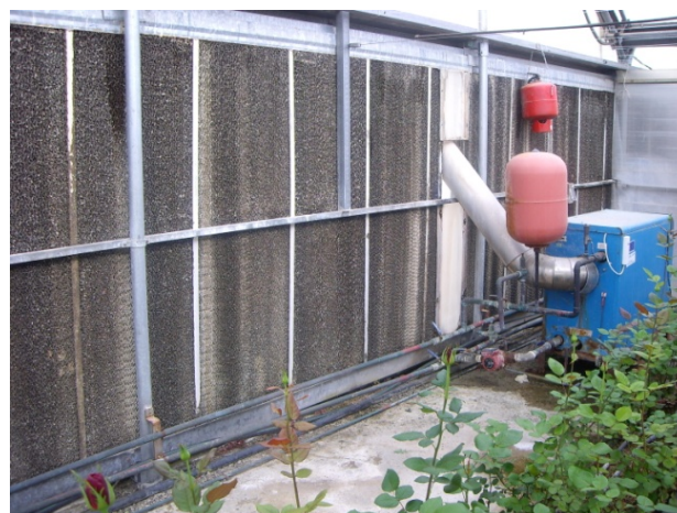
Figura 25. Refrigeración mediante pantalla húmeda o cooling system . (Fuente: elaboración propia).
