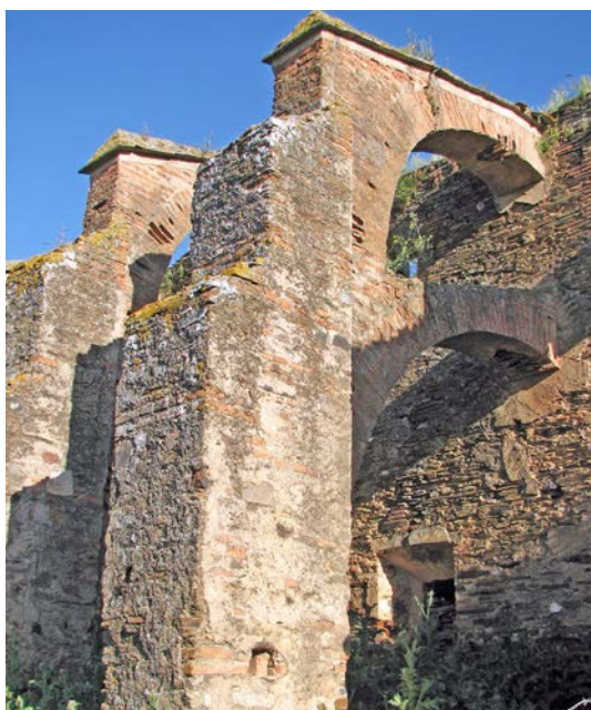
Figura 27. San Isidro de Loriana. Detalle de los contrafuertes que soportan la fachada sur.
