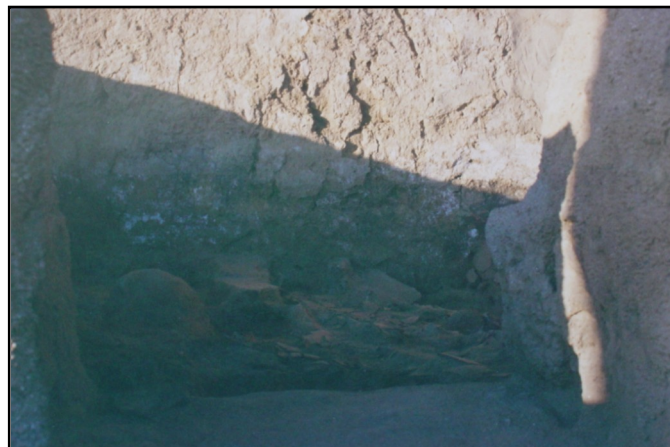
IMAGEN 10. DAÑOS CAUSADOS EN LOS MUROS DEL EDIFICIO, DEBIDO A LA FALTA DE CUBIERTA, CAUSADOS POR LA LLUVIA
