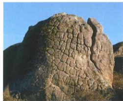
Fig. 4. Agrietamiento poligonal en bolo granítico.
