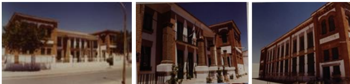
157-159. Colegio "San José de Calasanz" antes de la reforma. Fuente del Maestro.
