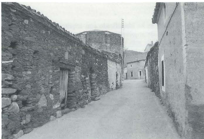
FIG. 11. La desnudez de los paramentos nos deja ver su interior (Retamosa).
