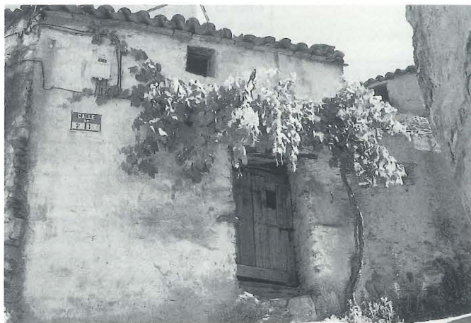
FIG. 9. Vivienda abandonada abocada a desaparecer (Roturas).
