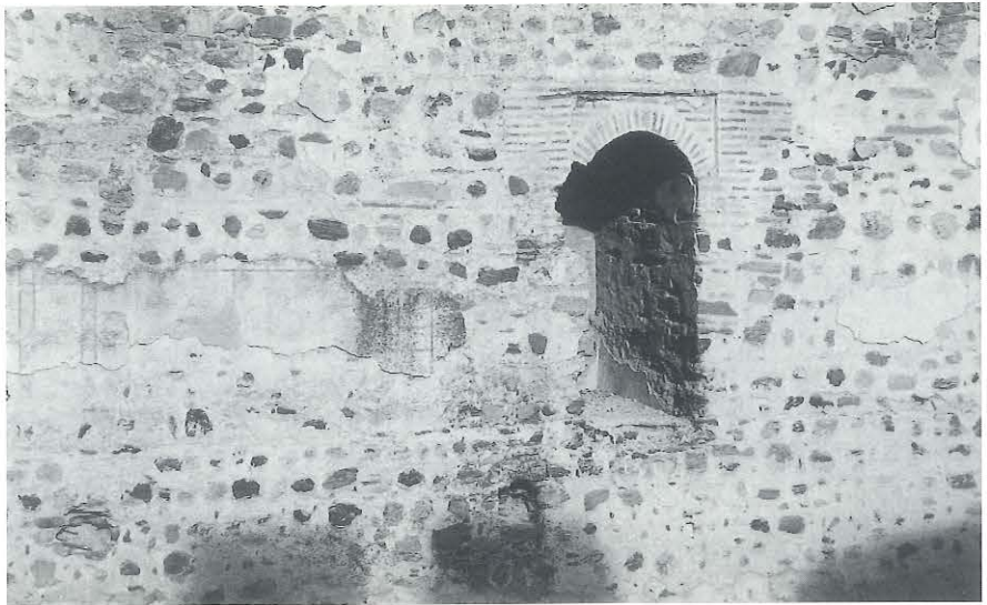
FIG. 4. Detalle de la decoración pictórica mudéjar. Junto a la ventana de tipo mudéjar (medio punto enmarcada en alfiz) es posible apreciar los restos de la banda decorativa con motivos geométricos que recorría la galería superior de la fortificación.
