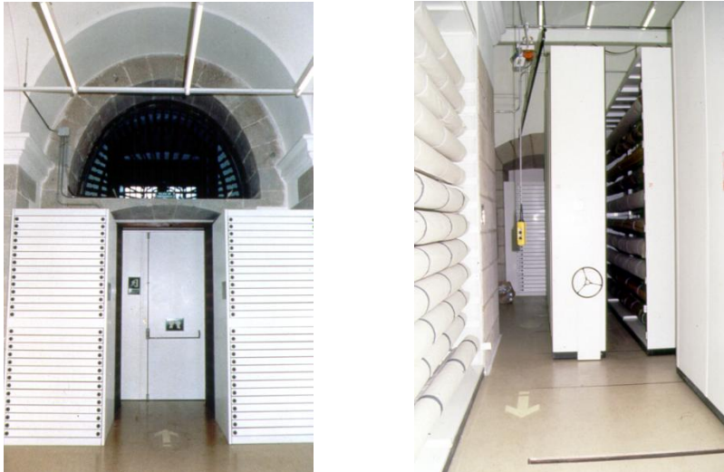
Fig. 8 y 9: Almacén de Tapices del Palacio Real de Madrid. Mobiliario de bandejas y baterías de cilindros. ©Patrimonio Nacional. Fotos de la autora.
