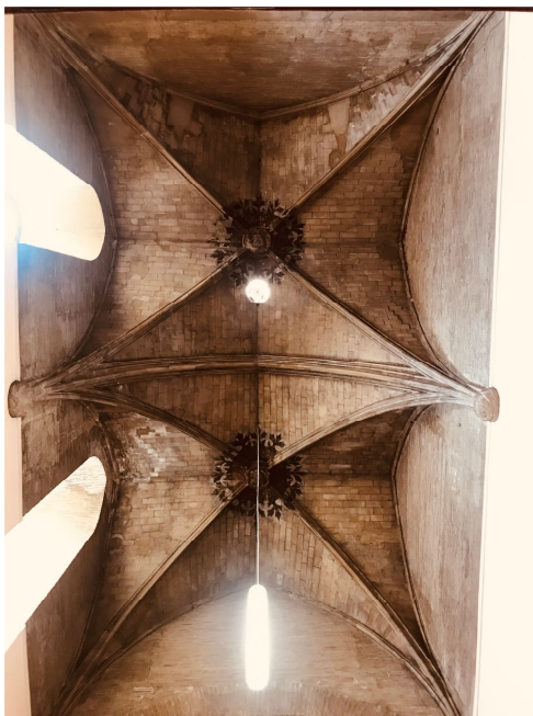
Fig. 6. Bóvedas de crucería descubiertas en la restauración de Íñiguez Almech, cubren el cuerpo de la nave de la Parroquieta, catedral de San Salvador de La Seo, Zaragoza. Estado actual. Foto de la autora.
