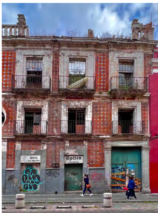
Figura 5.14. Vista de un edificio del Centro Histórico de Puebla en mal estado de conservación. Calle 5 Sur, n° 304. © Alicia Díaz Mayordomo, 2022.
