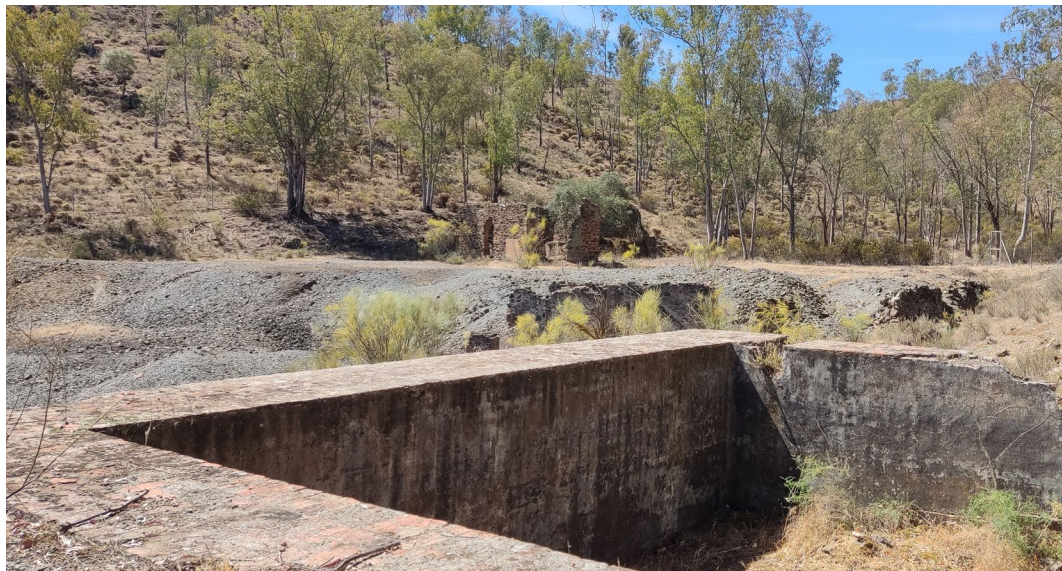
Figura 21. Infraestructuras abandonadas Mina La Sierra (Azuaga, Badajoz).
