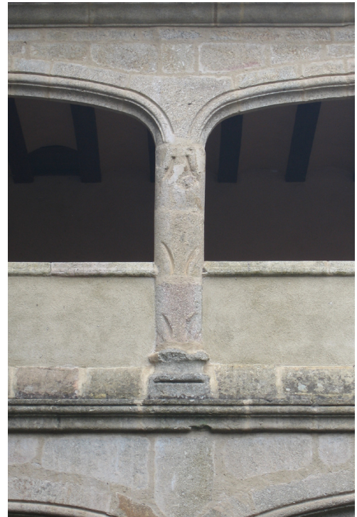
Antepecho del piso superior del claustro gótico tras la intervención de Hispania Nostra
