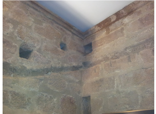
Detalle de la roza de la altura primitiva del tejado del palacio carolino
