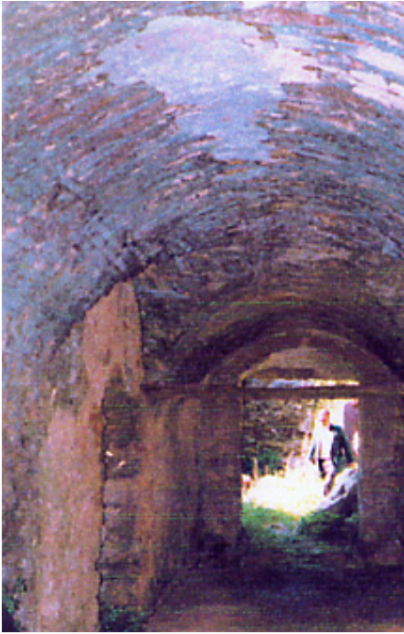
Estado de las bóvedas de la Casa del Obispo antes de la intervención de Hispania Nostra
