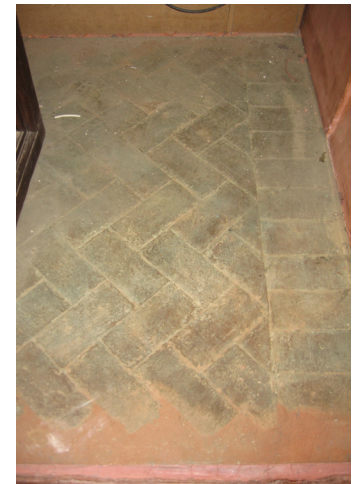
Restos del solado original del palacio en la puerta de comunicación entre el oratorio (dormitorio) y la llamada “Sala de don Juan de Austria”
