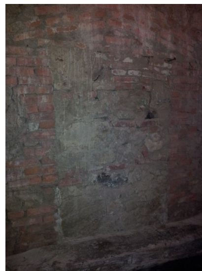
Restos de la puerta de separación entre la bodega alta y el refectorio
