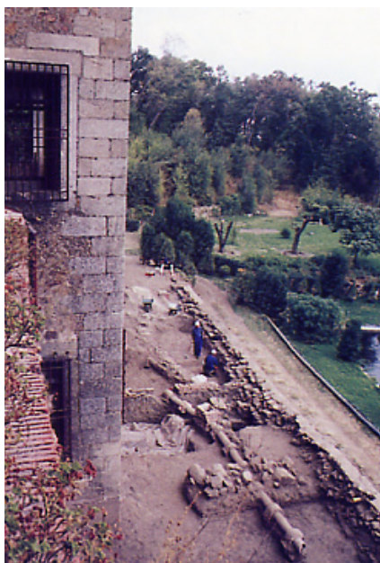
Las operaciones para devolver al palacio su altura primigenia permitió el descubrimiento de infraestructuras antiguas y modernas y el saneamiento de estas últimas
