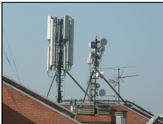
Figura 2: Estación base de telefonía móvil en la azotea de un edificio
