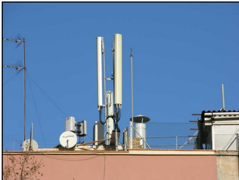
Figura 8: Antena de telefonía móvil en la azotea de un edificio
