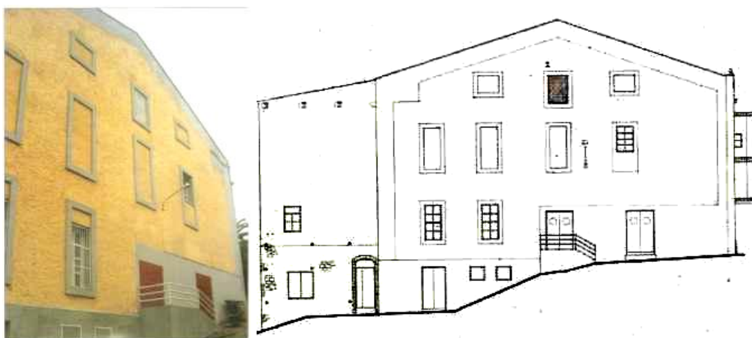
Figuras 731 y 732. Fachada lateral después de la rehabilitación (Foto P. Gato y Txisti) y plano de la fachada lateral con la construcción de la rampa de acceso y el cerramiento de los huecos de ventanas (ARIZA VIGUERA, D., 1994).
