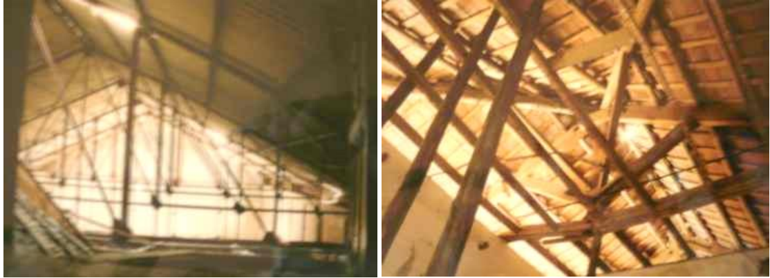
Figuras 833 y 834. Estructuras portantes de cubierta, metálica y de madera antes de la reforma (JAUREGUIBEITIA J.M., 1995).
