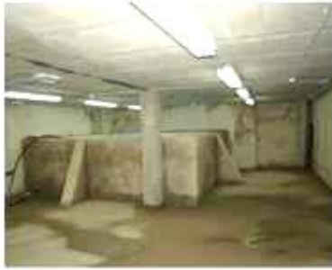
ALJIBE PARA INCENDIO EN SÓTANO
