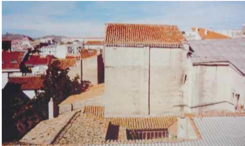
Figura 563. Alzado posterior, en la parte superior se encuentra el casetón del escenario. La salida de humos que está adosada pertenece a la caldera. En la parte inferior de la foto nos encontramos (a la izquierda) el almacén de decorados, y a la derecha la Casa de los Toledo Barrantes (VALVERDE LORENZO, L.R, 1996).
