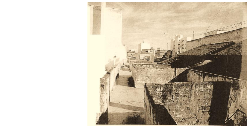
Figura 391. Cubierta de fibrocemento de la sala que en un principio evitó el deterioro del artesanado de madera. Figura 392. Artesonado de la sala de espectáculos. Figura 393. Vista de la cubierta plana con los patios de ventilación del edificio racionalista. (TEIJEIRO FUENTES, J., 1998).
