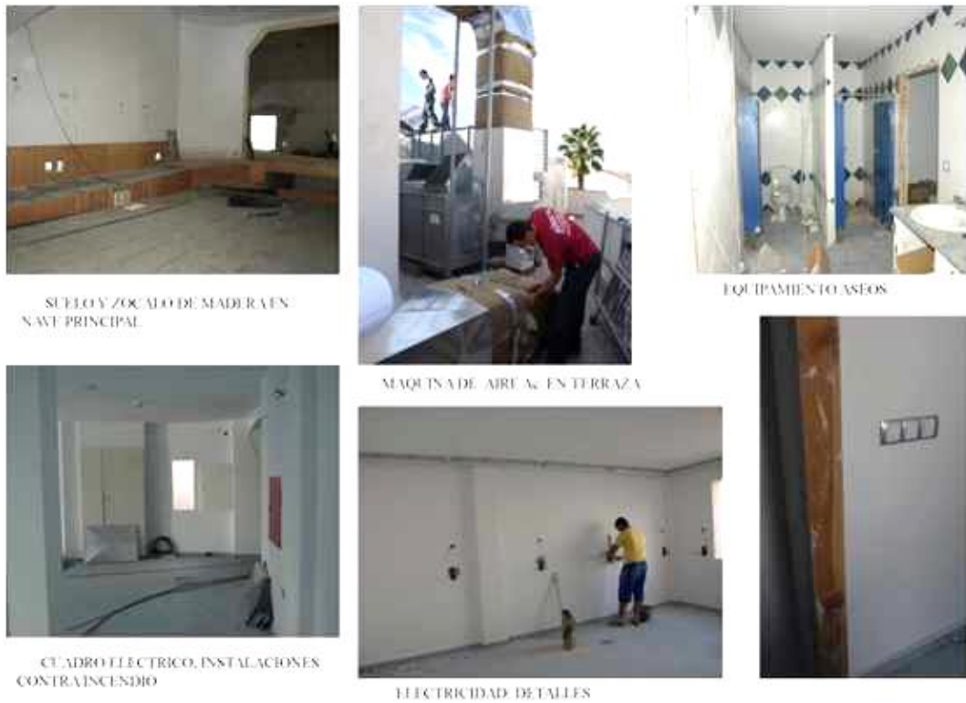
Figura 810. Suelo y zócalo de madera en nave principal, maquinaria de aire en terraza, equipamientos aseos, cuadro eléctrico de instalaciones contraincendios y electricidad (GALLEGO CANO, A.).
