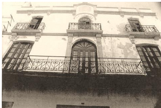
Figura 387. Detalle de fachada principal con problemas de humedad (TEIJEIRO FUENTES, J., 1998).
