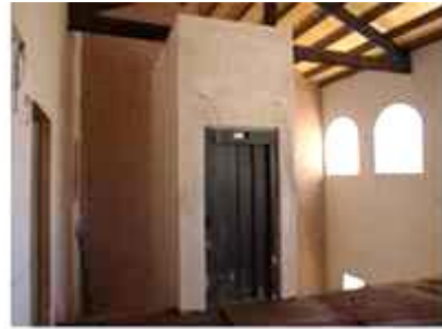
ASCENSOR. DETALLE DE CUARTO MAQUINARIA
