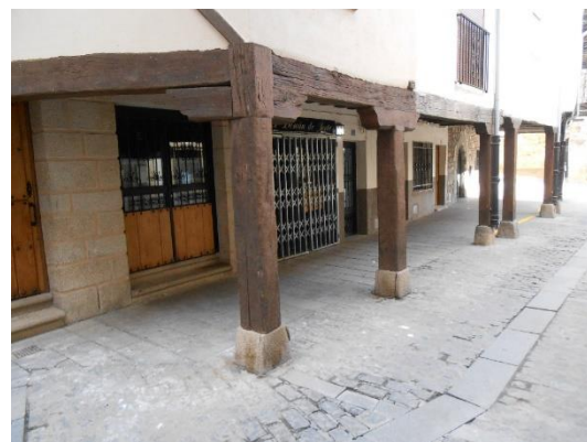
Figura 2.24: Soportales con postes de madera en Plaza de Independencia, Jerte, (elaboración propia).
