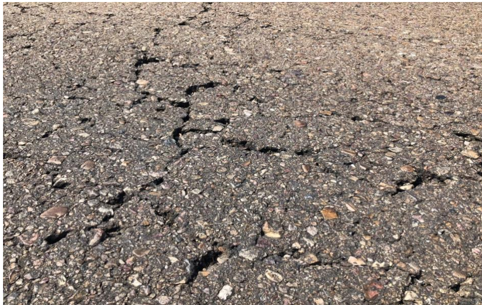
Imagen 2. Estado del firme.
