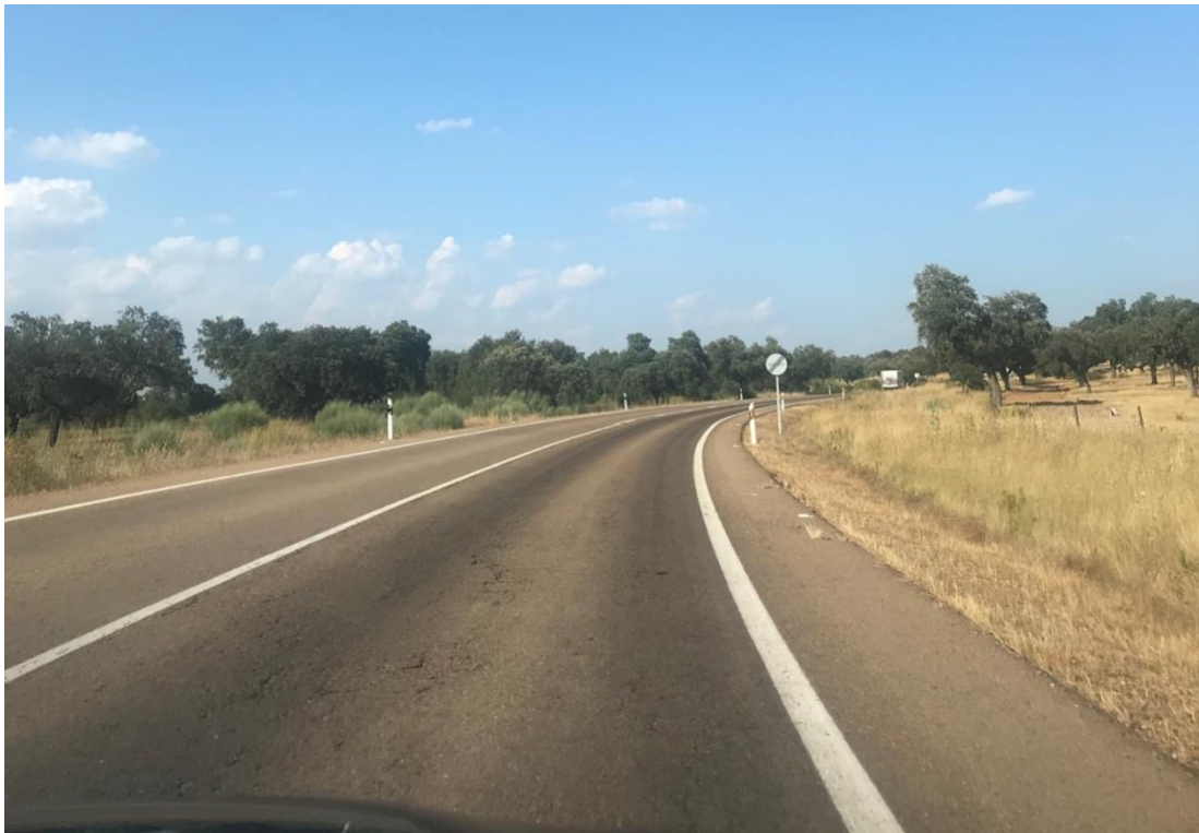
Imagen 5. Estado del firme.
