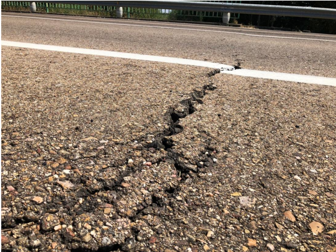
Imagen 4. Estado del firme.
