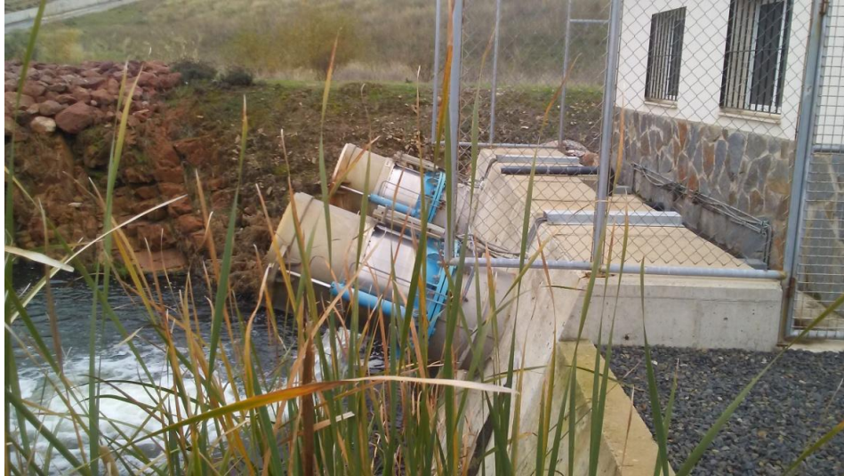
Figura 16: Vista exterior de los desagües de fondo con válvulas de chorro hueco cónico (Howell-Bunger) y salida de caudal ecológico.
